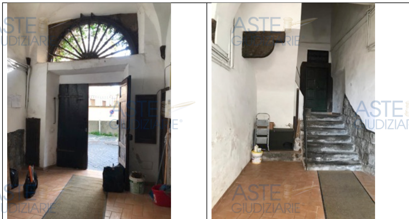
Portone condominiale di accesso al fabbricato - Androne e scala condominiale, con presenza di salnitro e umidità di risalita sulle pareti
