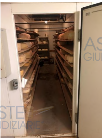
Cella frigorifera sala stagionatura
