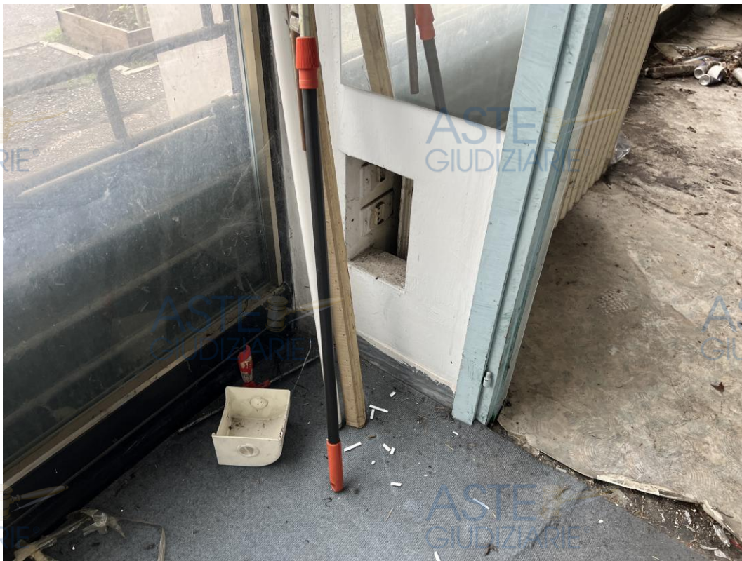
CONDIZIONE PAVIMENTO NEL LOCALE COMMERCIALE
