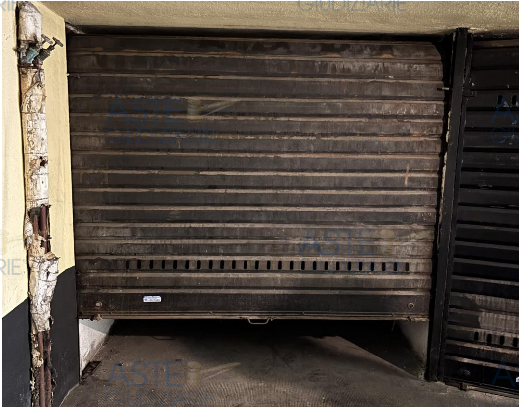
ACCESSO AL GARAGE – SERRANDA DANNEGGIATA
