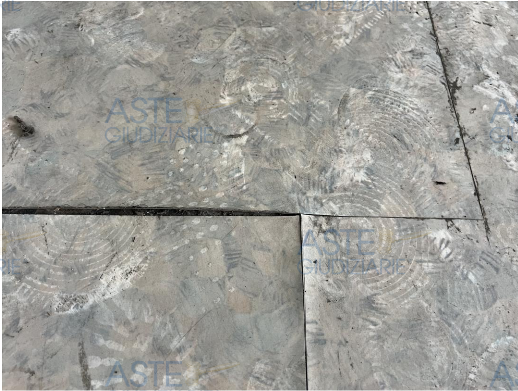
CONDIZIONE PAVIMENTO NEL LOCALE COMMERCIALE
