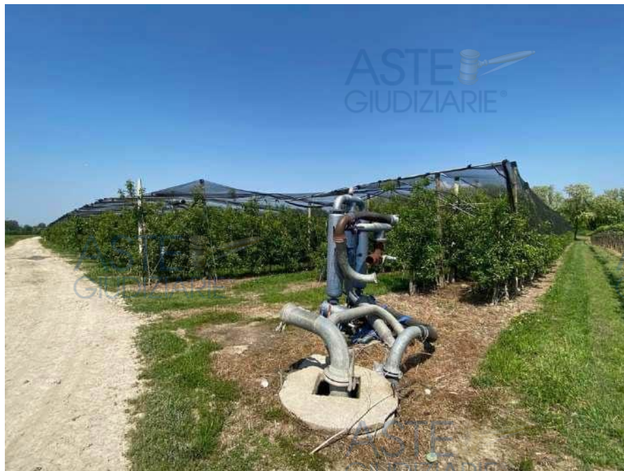
Mapp. 417 – Pozzo irriguo ed impianto pompe di sollevamento
