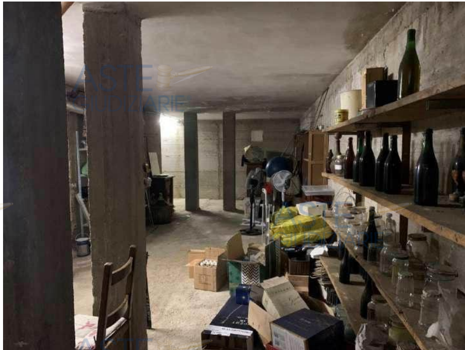
Mapp. 192 sub 2 - Deposito / Locale tecnico da sanare
