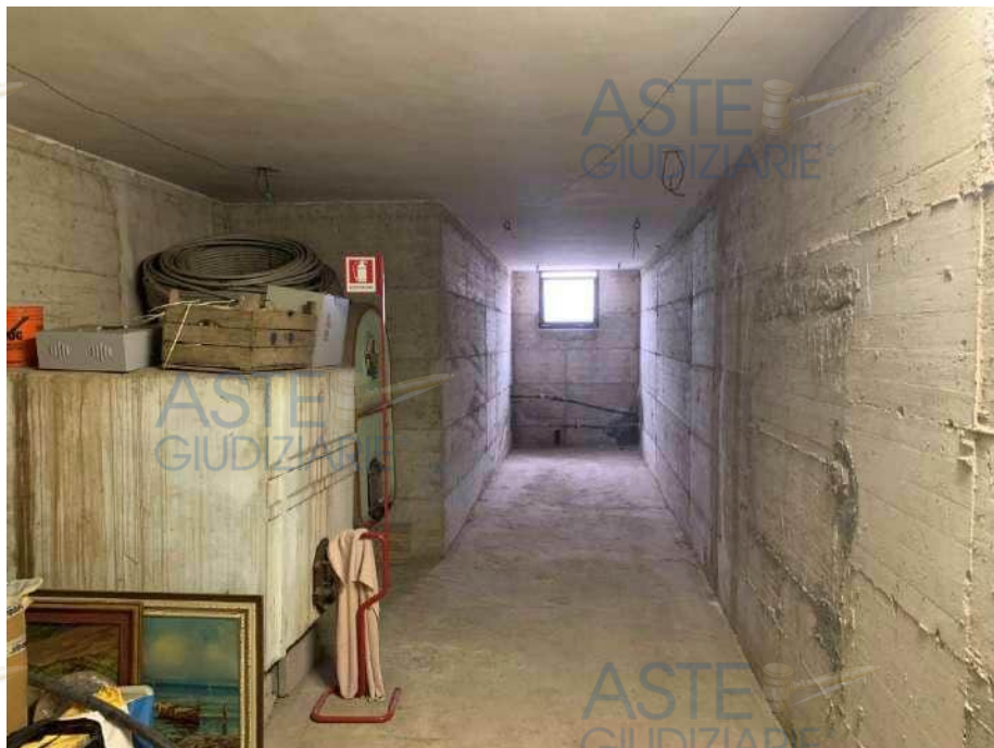
Mapp. 192 sub 2 - Deposito / Locale tecnico da sanare
