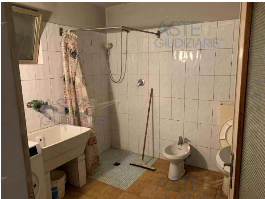
Mapp. 491 - Bagno 1 da ripristinare come da progetto
