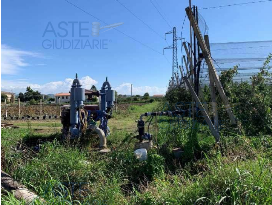
Mapp. 20: Pozzo irriguo ed impianto pompe di sollevamento
