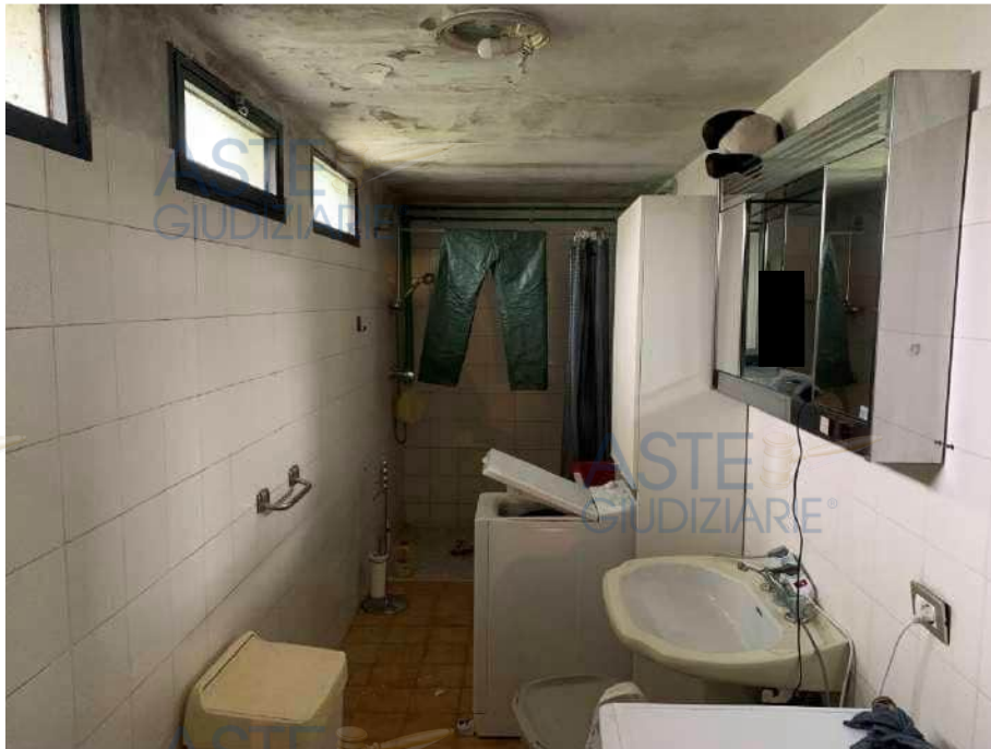
Mapp. 192 sub 2 - Intercapedine - Bagno da rimuovere -
