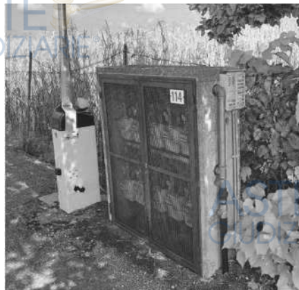
Figura 11: nicchia contatori situata all'inizio dello stradello
