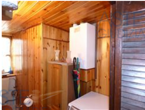
Caldaia produzione acqua calda
