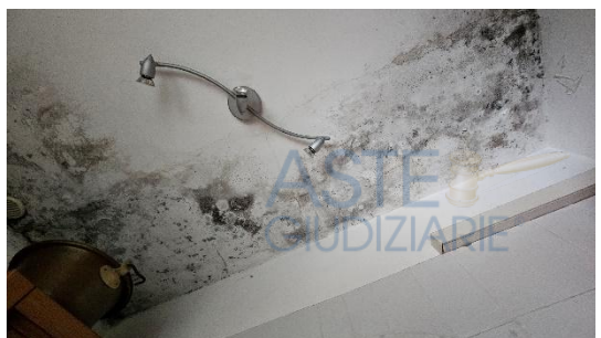
Muffa sul soffitto del cucinino
