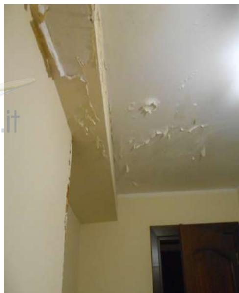
14. VASTE MACCHIE DI UMIDITÀ DERIVANTI DA INFILTRAZIONI
