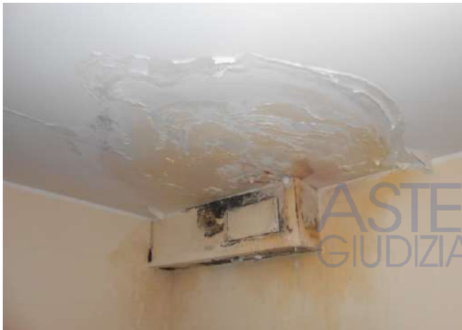
17. VASTE MACCHIE DI UMIDITÀ AL PIANO S1
