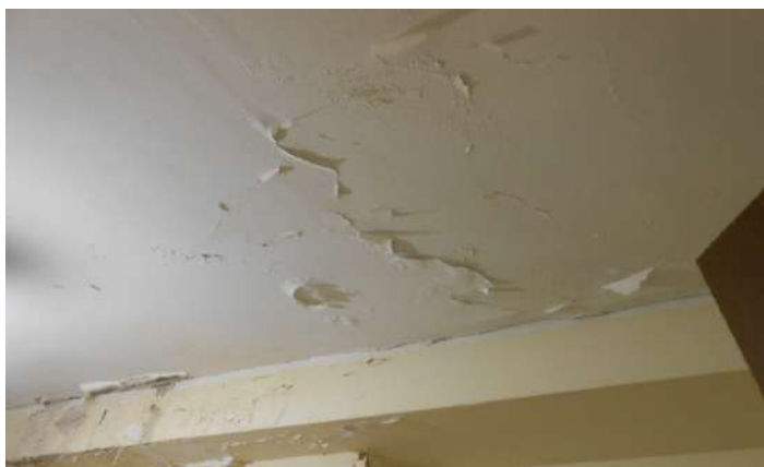
18. VASTE MACCHIE DI UMIDITÀ AL PIANO S1
