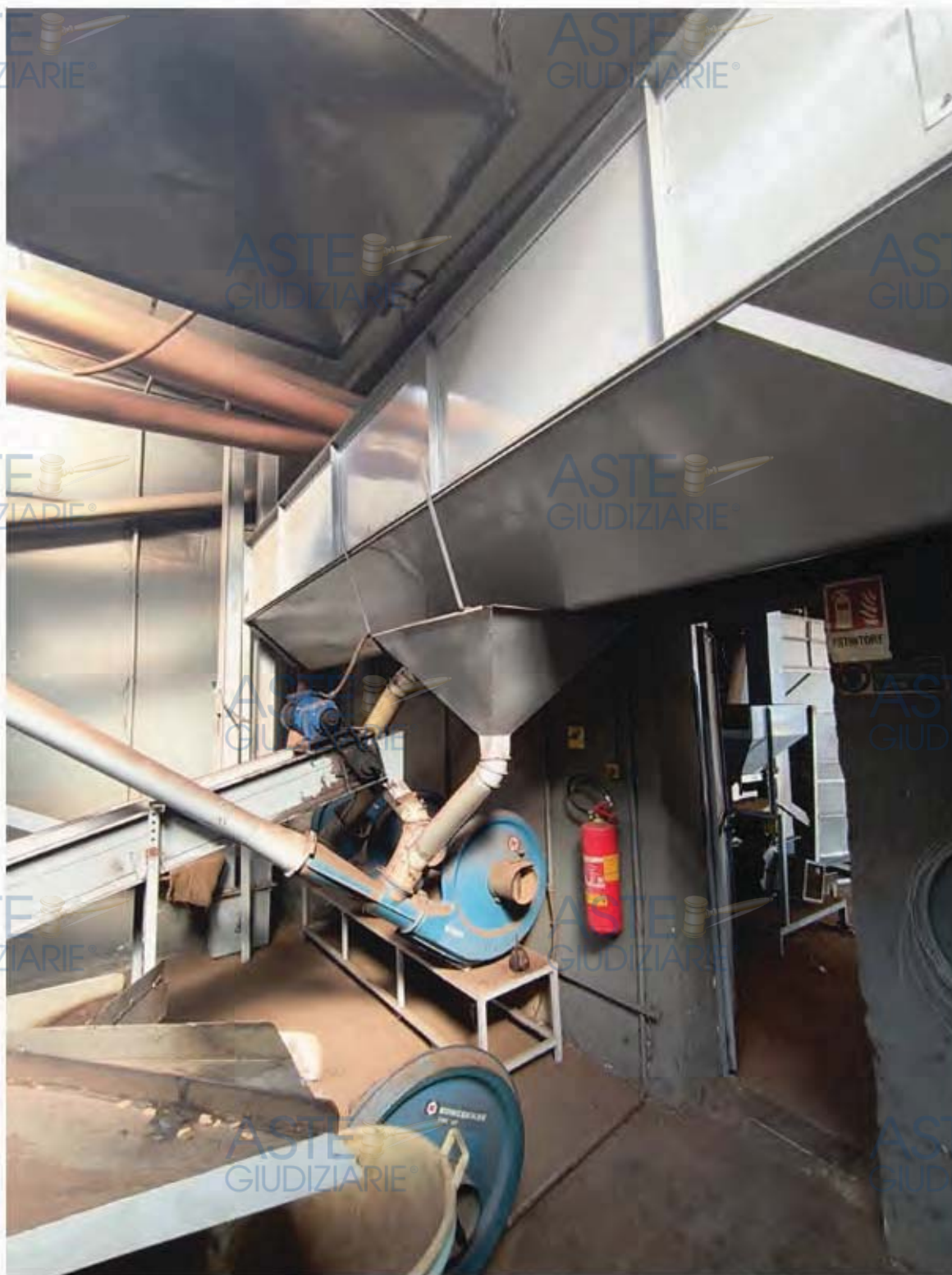
MACCHINARI DELLA LINEA 2 DELLO STABILIMENTO DI TORRE DEL GRECCO NASTRO TRASPORTATORE
