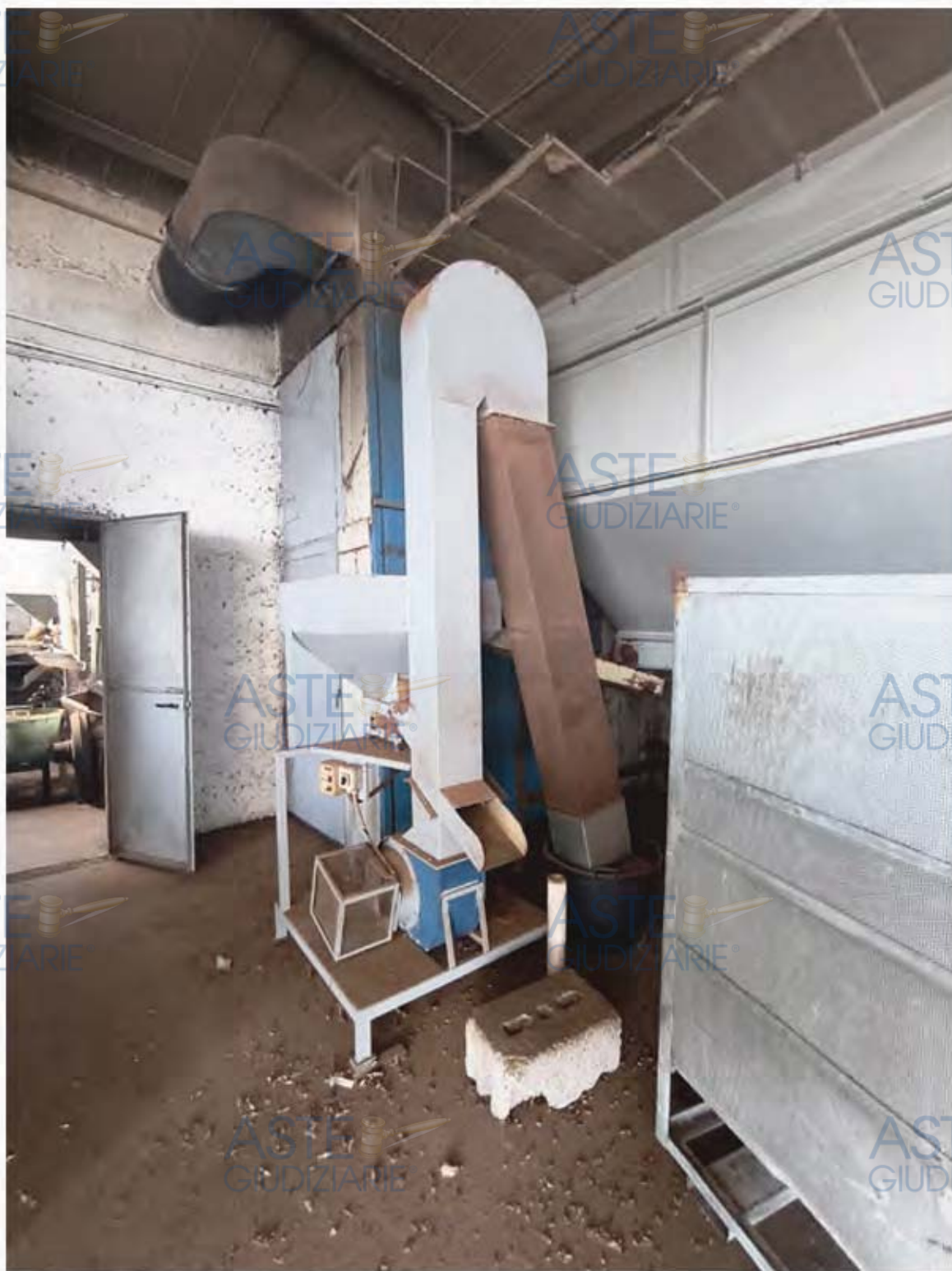
MACCHINARI DELLA LINEA 2 DELLO STABILIMENTO DI TORRE DEL GRECO
