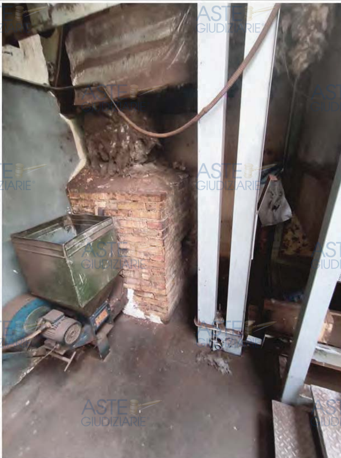
MACCHINARI DELLA LINEA 2 DELLO STABILIMENTO DI TORRE DEL GRECCO FORNO IN MURATURA
