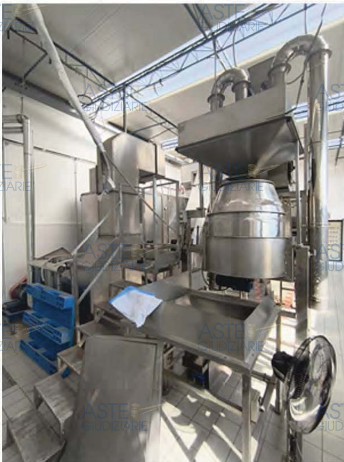
MACCHINARI DELLA LINEA 3 DELLO STABILIMENTO DI TORRE DEL GRECO
