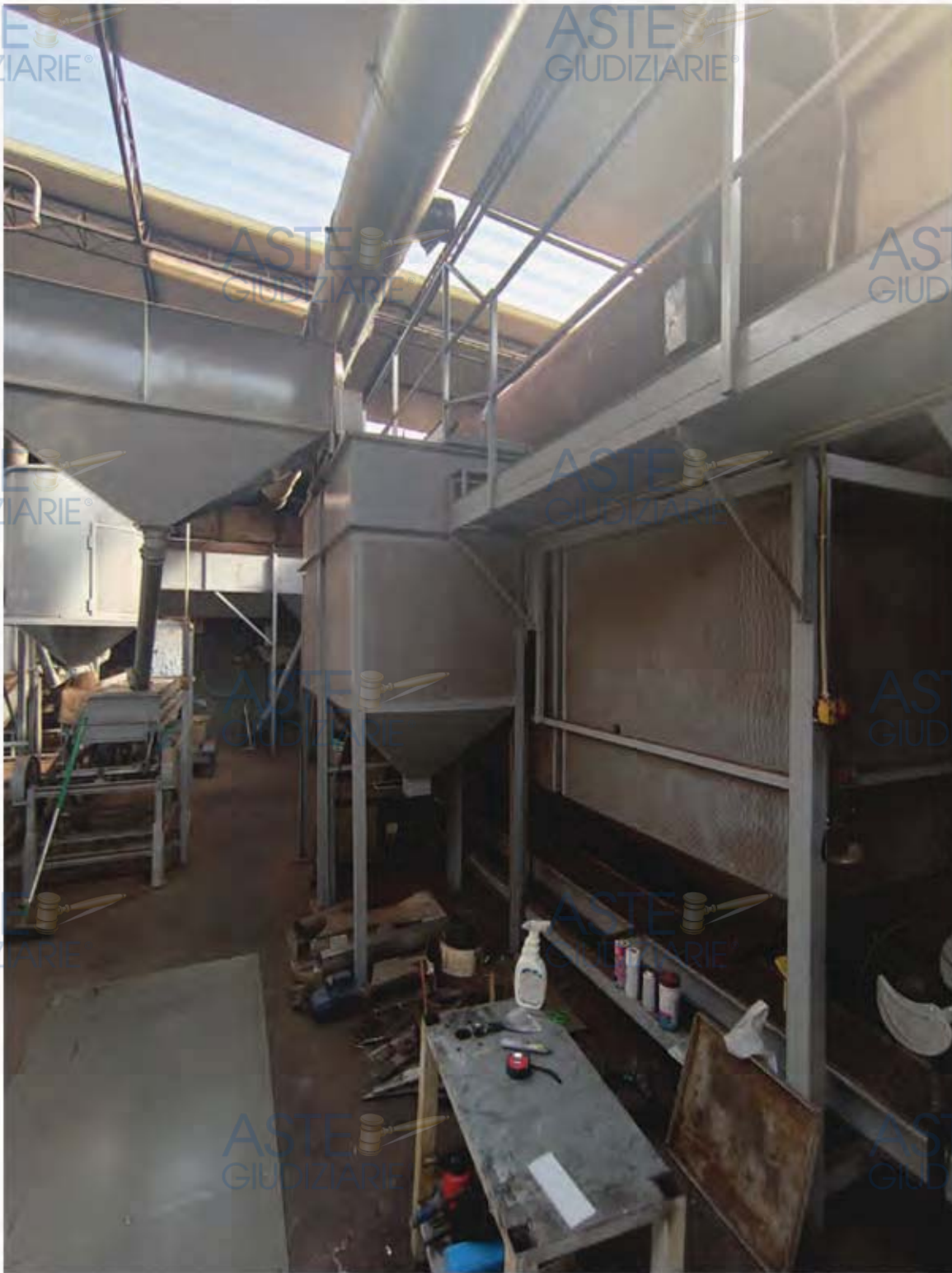
MACCHINARI DELLA LINEA 2 DELLO STABILIMENTO DI TORRE DEL GRECO ESSICCAZIONE
