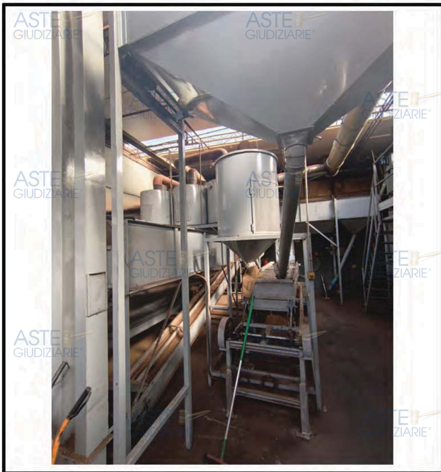
MACCHINARI DELLA LINEA 3 DELLO STABILIMENTO DI TORRE DEL GRECO
