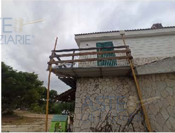
Foto n.7 - Manufatti precari da rimuovere
