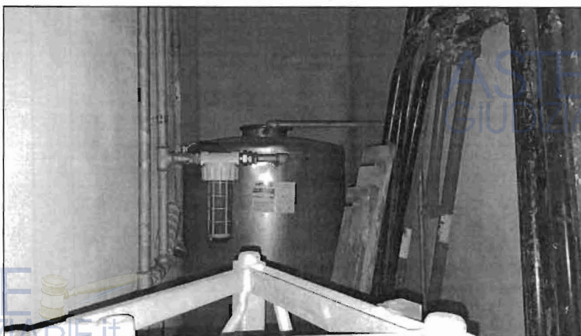
Foto 18 – Cisterna in acciaio zincato acqua potabile a servizio impianto idrico della unità immobiliare.
