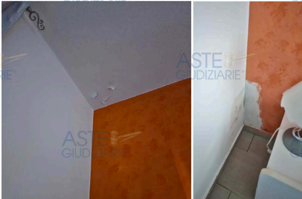
Figura 6 – Forme di ammaloramento dell'unità immobiliare
