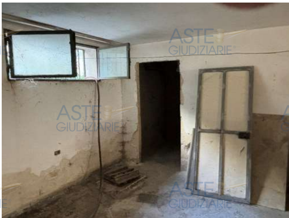
FOTO – LOCALE TECNICO 13
