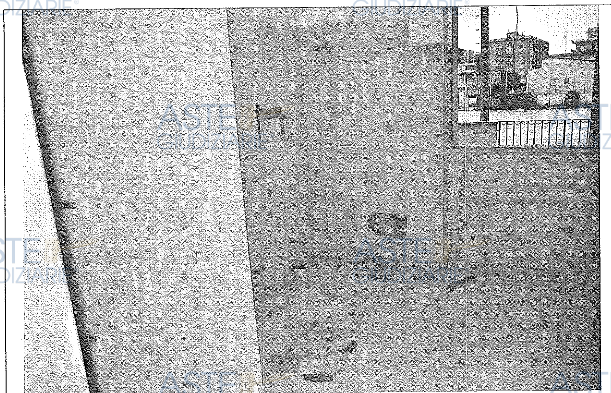
Foto n. 37 – Servizio igienico privo di sanitari
