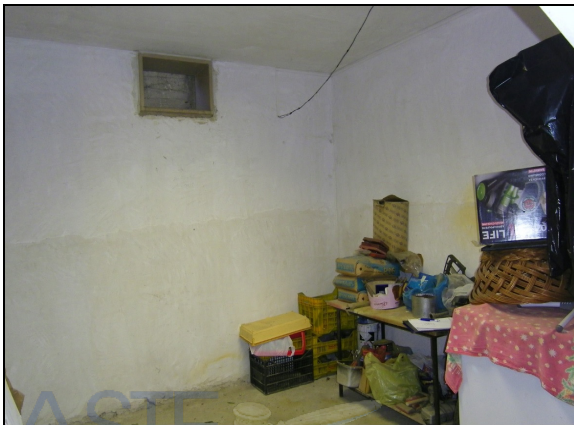
Foto 5 - deposito al piano interrato
