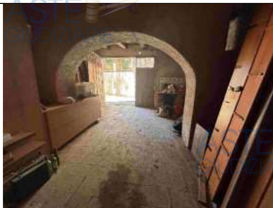
Interno locale terraneo sub 10
