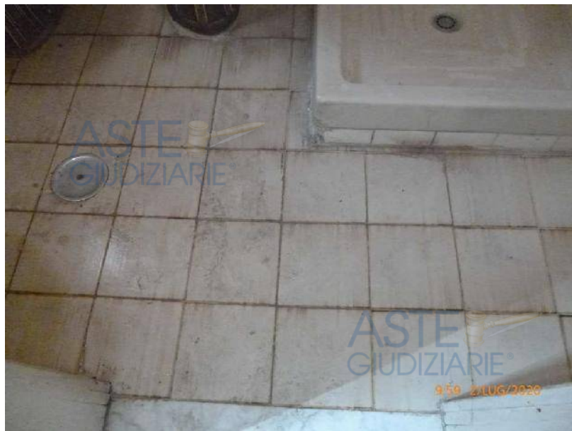
Foto 50 – Particolare della pavimentazione particolarmente vetusta.
