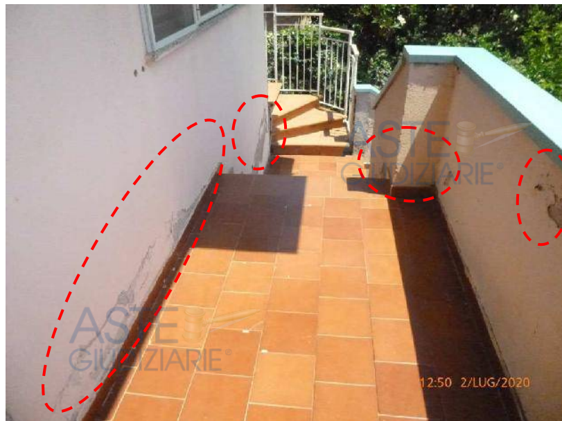
Foto 76 - Ballatoio a cui si accede tramite due rampe di scale, con pavimentazione in sufficienti condizioni di manutenzione e tracce di infiltrazioni, con conseguente distacco degli intonaci, presenti sul prospetto esterno del villino e sul muretto che delimita la rampa stessa.
