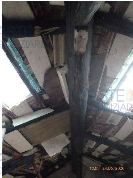
Foto 63 - Particolare della copertura che appare in pessime condizioni, con materiali improvvisati che sarebbero stati utilizzati probabilmente per porre rimedio a criticità emerse.
