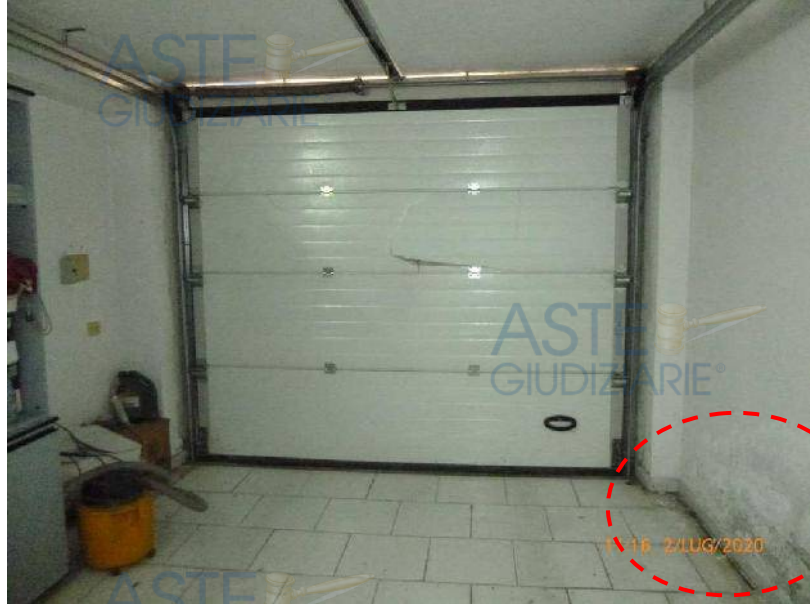
Foto 77: Accesso all'autorimessa inquadrato dall'interno; si notino le tracce di umidità presenti sulle pareti.
