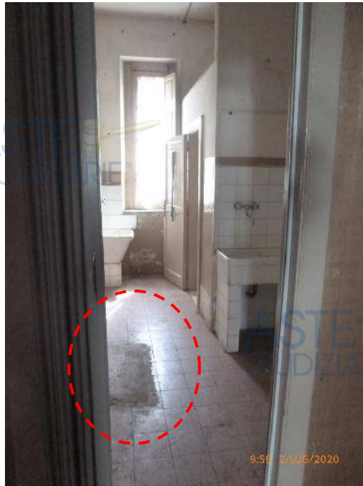
Foto 47 – Vista della cucina con particolare della porta a soffietto e della pavimentazione in pessime condizioni in alcuni punti.
