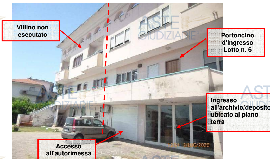
Foto 73 – Prospetto principale del villino, con ampie porzioni interessate dal distacco dell'intonaco. Si notino gli accessi al piano terra ed al piano primo, nonché il confine ideale tracciato per distinguere il villino eseguito dall'altro in adiacenza.
