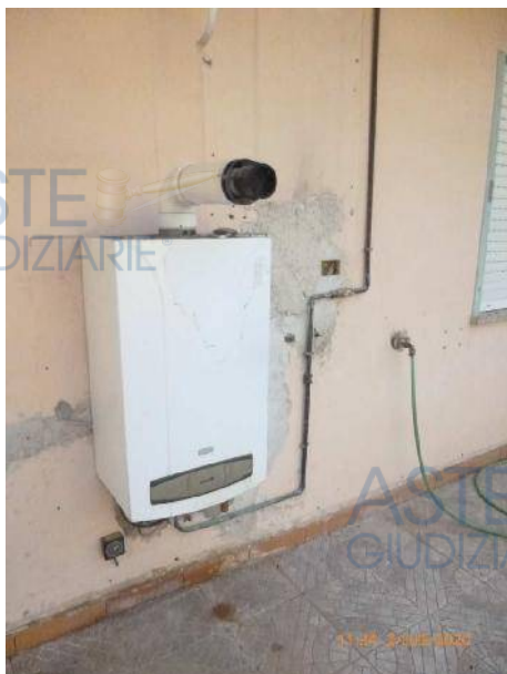
Foto 99: Caldaia dell'impianto termico ubicata sul terrazzo adiacente al giardino sul fronte nord.
