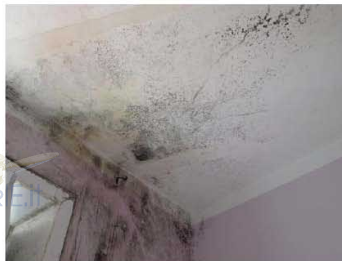
Foto 10: Significativa presenza di umidità, presenti in camera da letto
