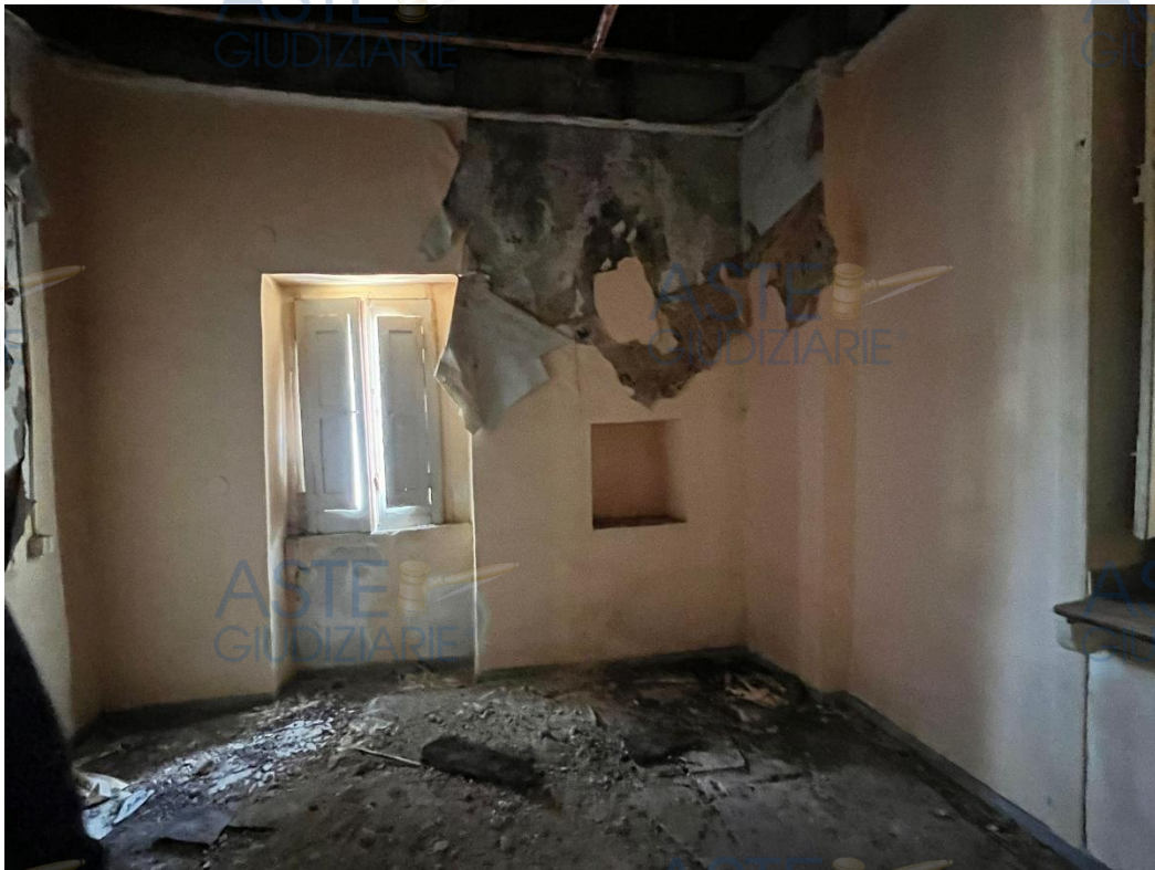
Foto 4 – Vista degli interni dell’Abitazione con pavimenti, pareti, solai e impiantistica da recuperare.
