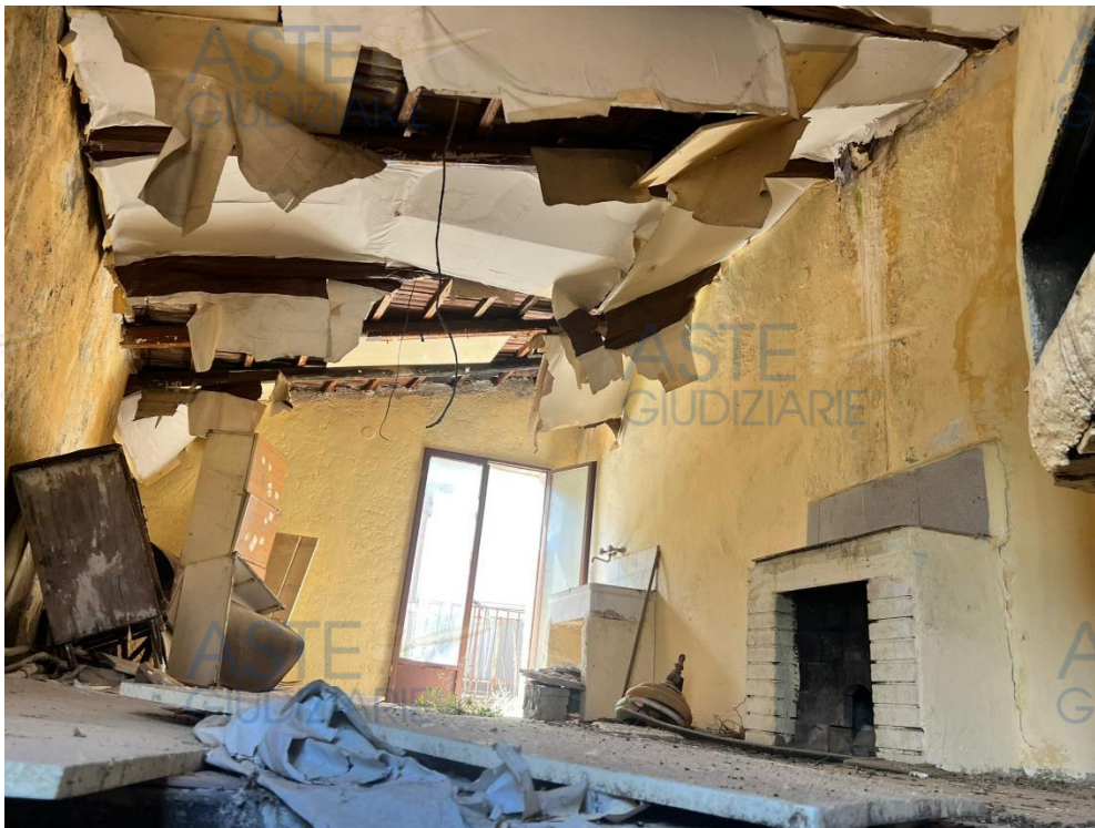
Foto 7 – Ulteriore vista degli interni dell’Abitazione, con controsoffittature da rimuovere e solai da rifare.
