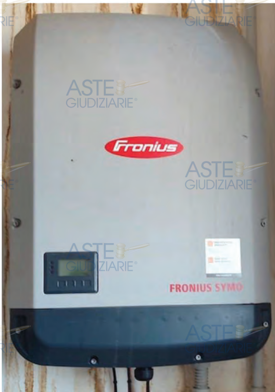
Foto 11 – Inverter per impianto fotovoltaico di 15 kW
