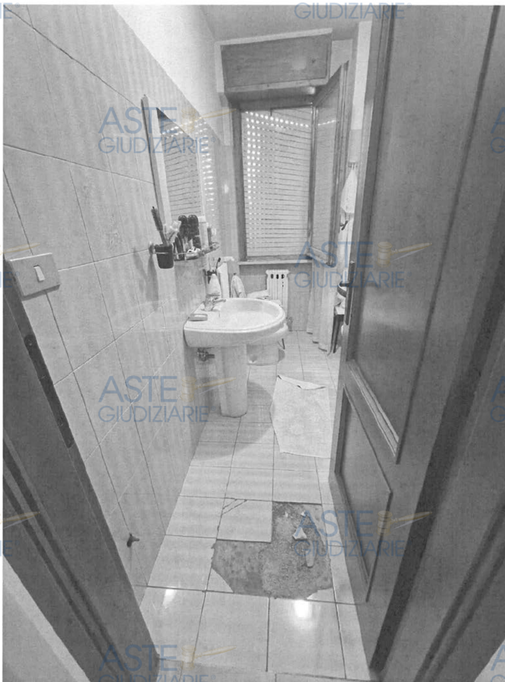
foto 6: pavimentazione mancante nel bagno
