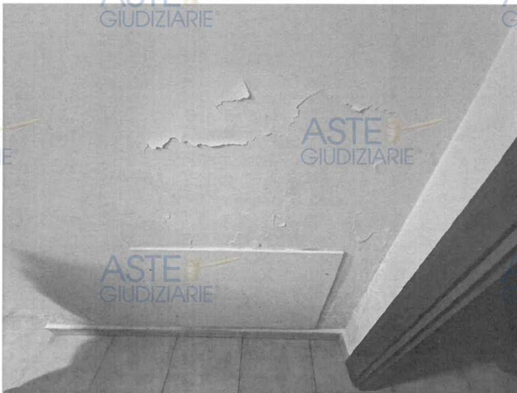
foto 1 : infiltrazione zona collettore
