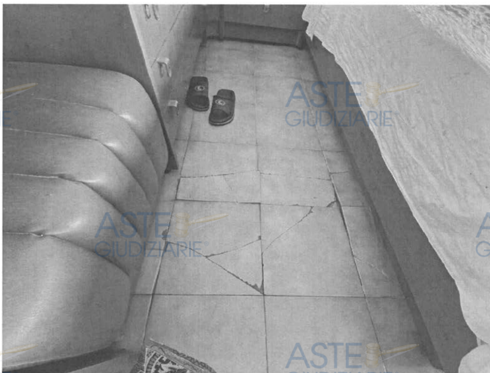
foto 4: pavimentazione lesionata nella zona notte
