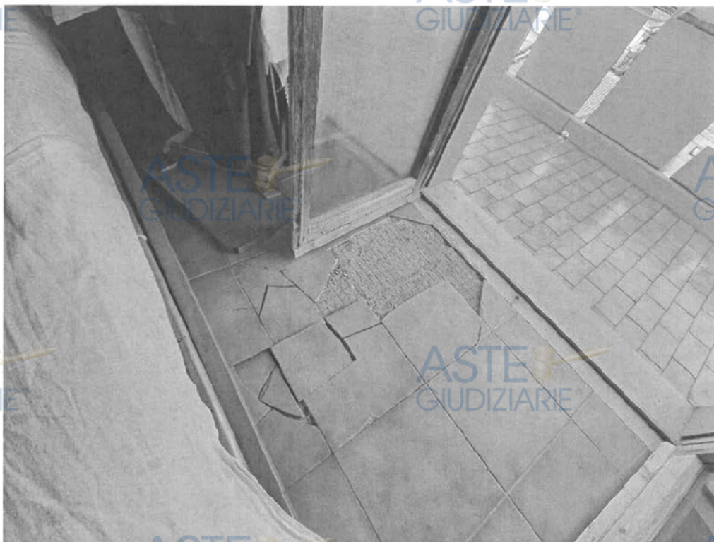
foto 5: pavimentazione mancante nella zona notte
