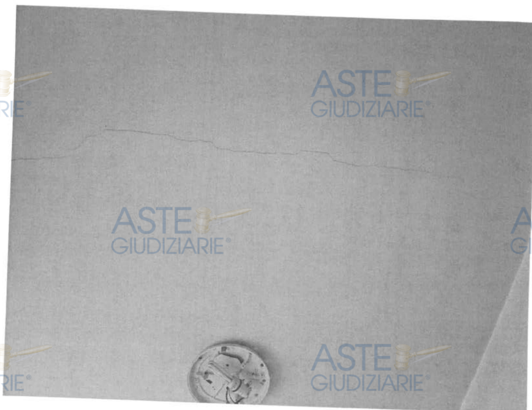
foto 3: lesione sul solaio interpiano zona disimpegno
