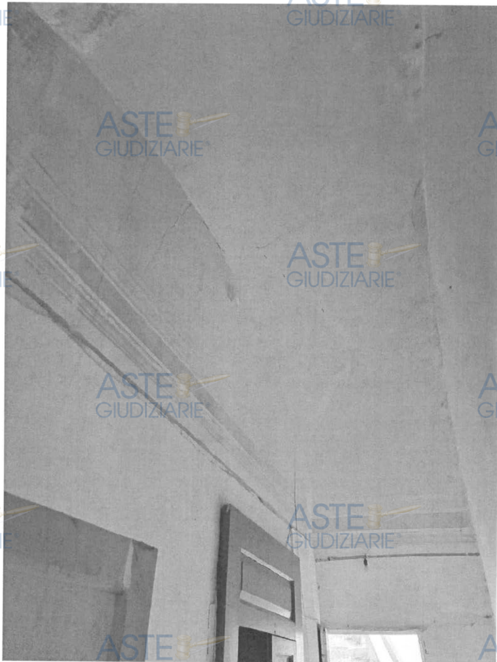
- Foto 12 – foto interna: lesioni
