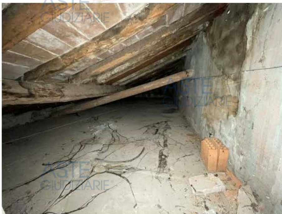
Fot. N. 18: locale non accessibile – P. sottotetto
