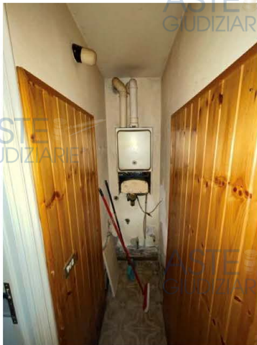
Fot. N. 26: Caldaia
