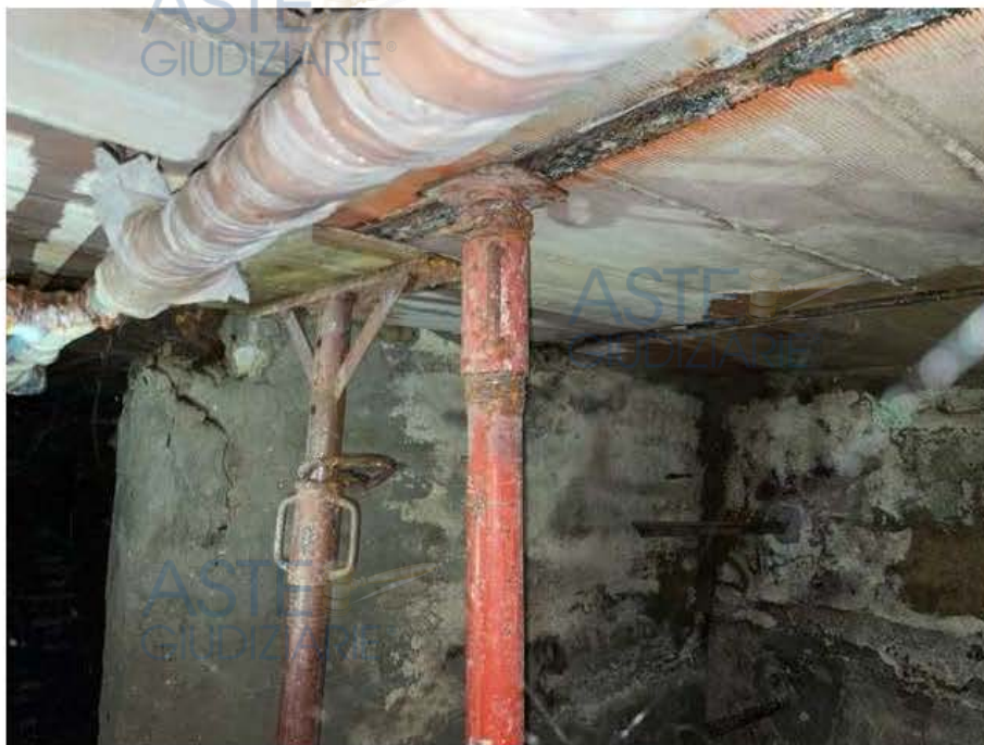
Fot. N. 23: Disimpegno alle cantine – dettaglio putrella in ferro puntellata
