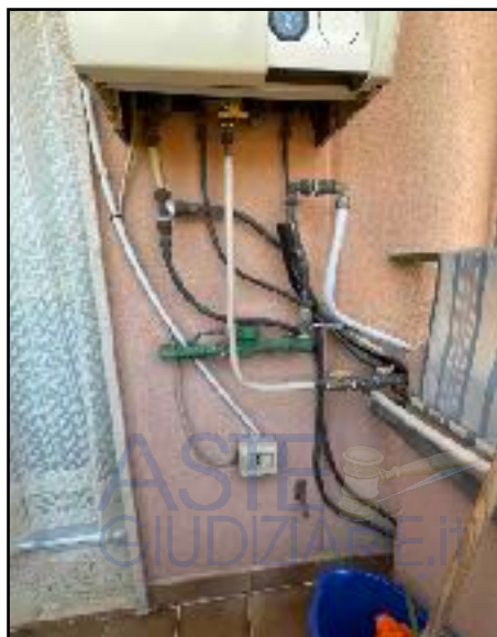
Fig.28 Caldaia sul balcone
