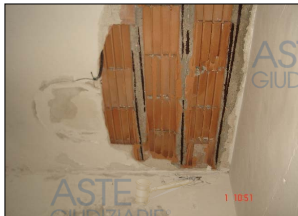
Foto n. 12 – Vista soffitto danneggiato w.c.-bagno
