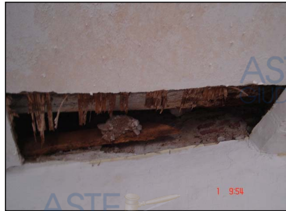
Foto n. 8 – Vista soffitto danneggiato
