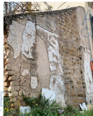
Foto 10 resti muro comune unità 839 e 845
