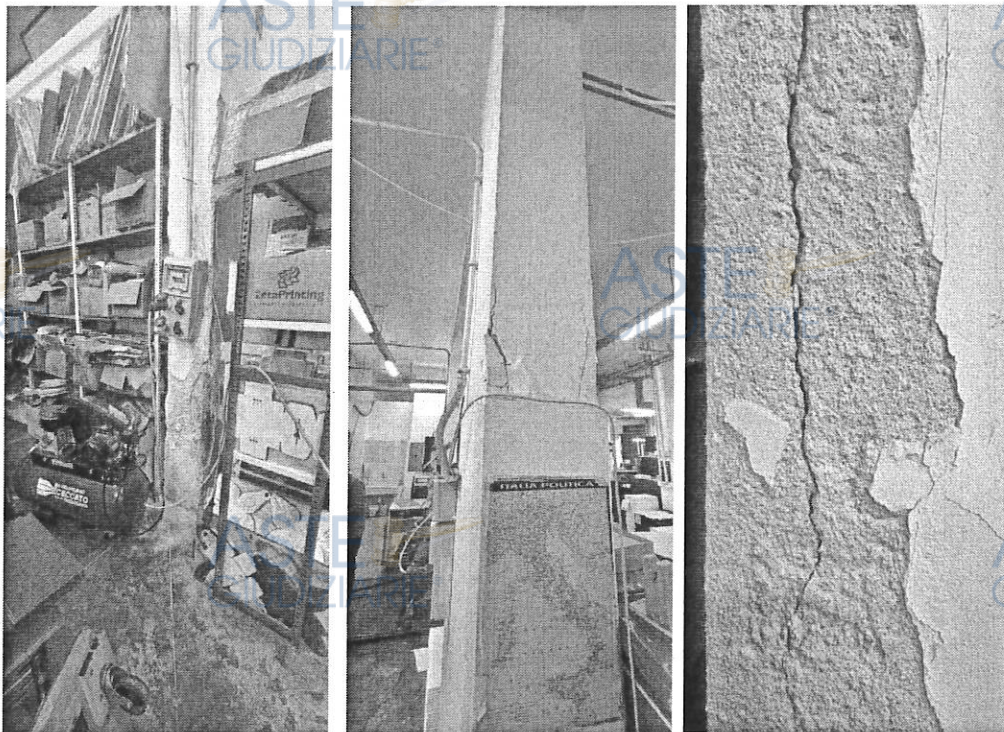
Figure 11 - 12 -13 – Pilastri interni particolarmente degradati con fenomeni fessurativi diffusi
