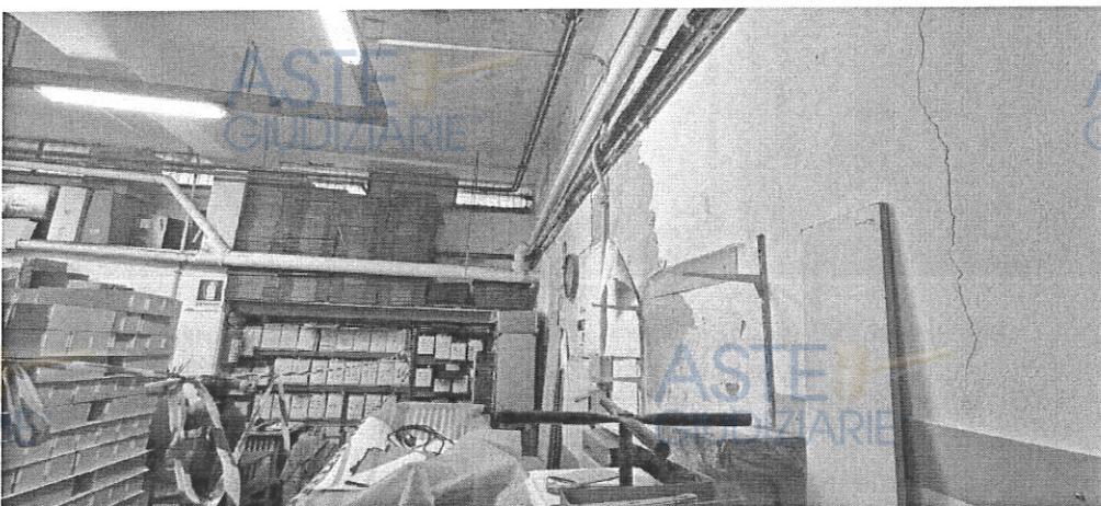
Figura 16 – Vista laterale della parete controterra in cui sono apprezzabili le lesioni verticali che presumibilmente sono corrispondenti alle sottostanti armature
