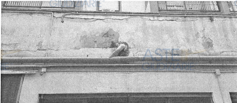
Figura 7 – Lesioni e degradi diffusi localizzati in corrispondenza dell'innesto dei pluviali
