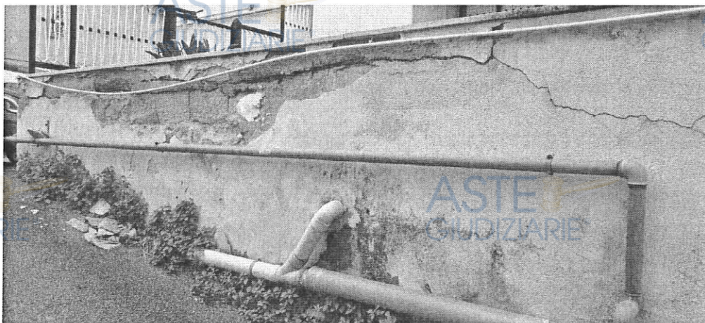
Figura 8 – Fenomeni di degrado, lesioni e distacco di intonaci
