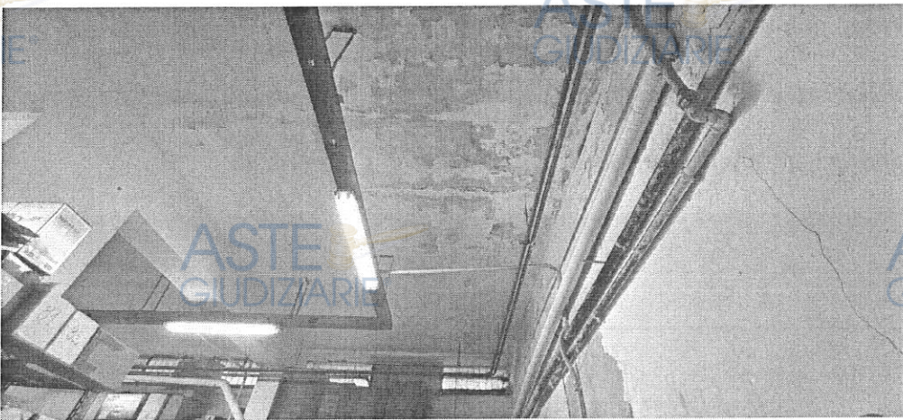
Figura 20 – Ammaloramento diffuso del solaio di copertura con alterazioni cromatiche
