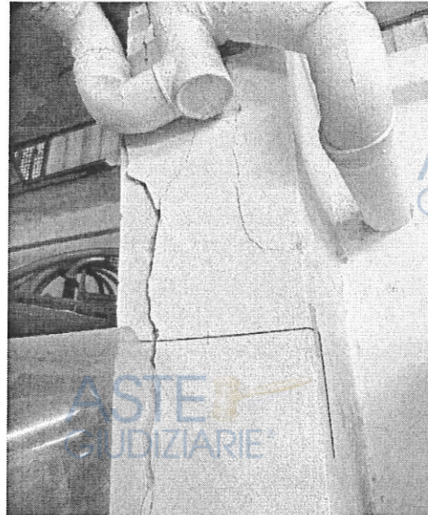
Fig. 5 Pilastro lesionato con tubazioni oggetto di stillicidio.
