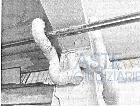
Fig. 22. Danni al soffitto ed al pilastro in corrispondenza della parete perimetrale prospiciente il retro dell'edificio.
