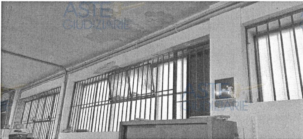
Figura 17 – Area operativa, degradi intradosso solai e travi perimetrali
