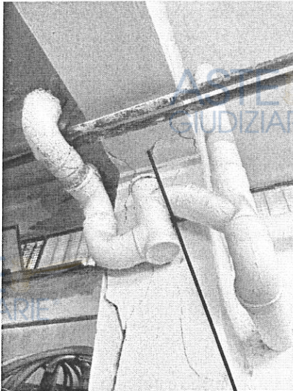
Fig. 1 Tubazioni di scarico delle acque bianche e nere, oggetto di stillicidio.
