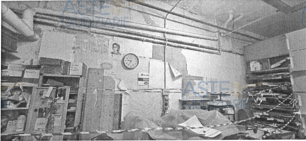
Figura 14 – Parete controterra in cui sono presenti fenomeni di degrado diffusi
