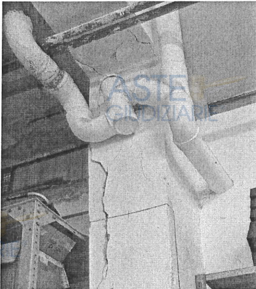
Fig. 4 Pilastro lesionato con tubazioni oggetto di stillicidio.
