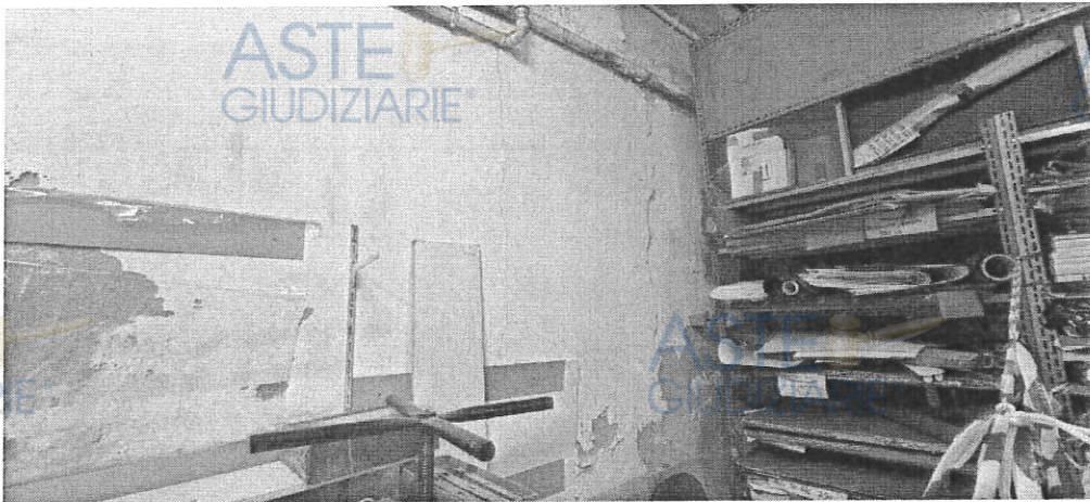
Figura 15 – Lesioni verticali presenti lungo la parete controterra
