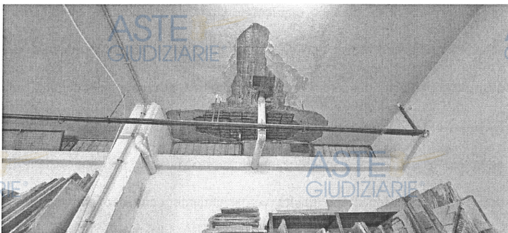
Figura 18 – Ammaloramento del solaio con distacco di intonaco nell'intorno dell'innesto dei pluviali
