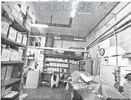
Fig. 24. Parete confinante con terrapieno, interessata da lesioni.
