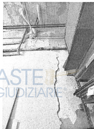
Fig. 25. Lesione sulla parete addossata al terrapieno
