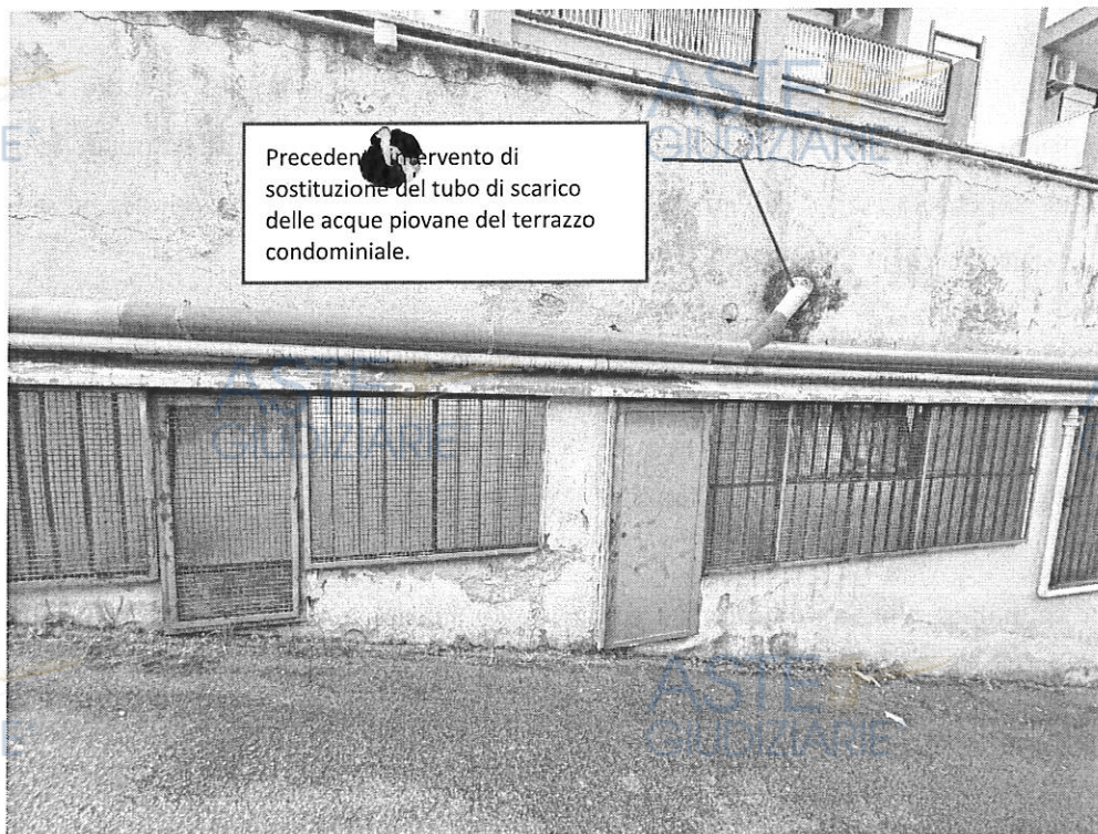
Fig. 17 . Tubazione di scarico delle acque piovane del terrazzo d'ingresso condominiale (foto dell'11/11/2025).
