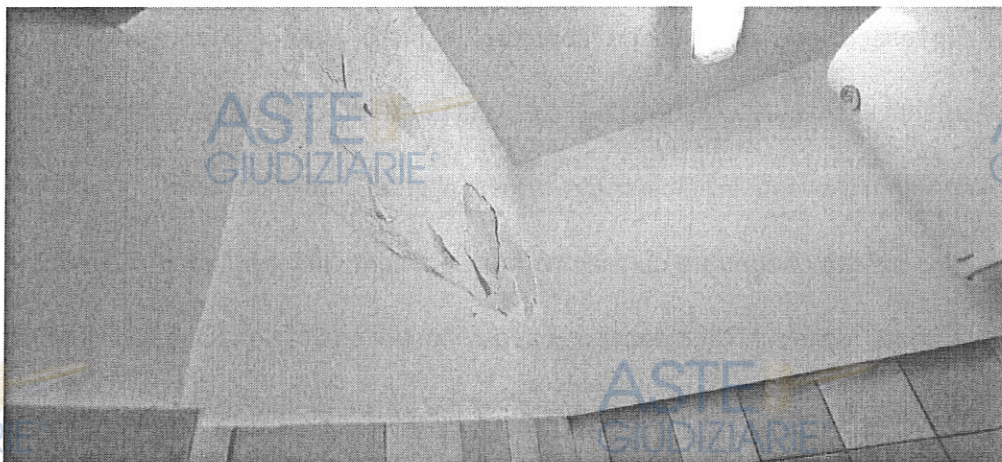
Figura 22 – Ammaloramento diffuso di una parete interna del WC
