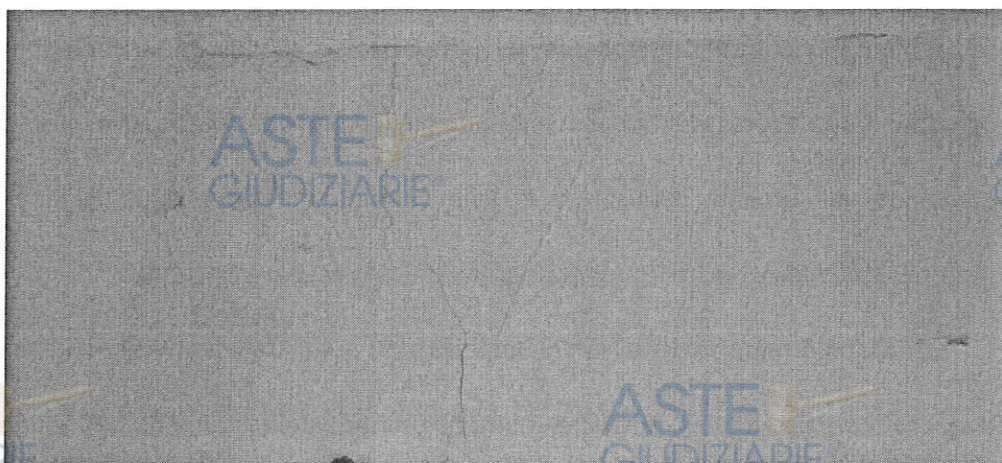
Figura 23 – Quadro fessurativo all'interno dei servizi igienici
