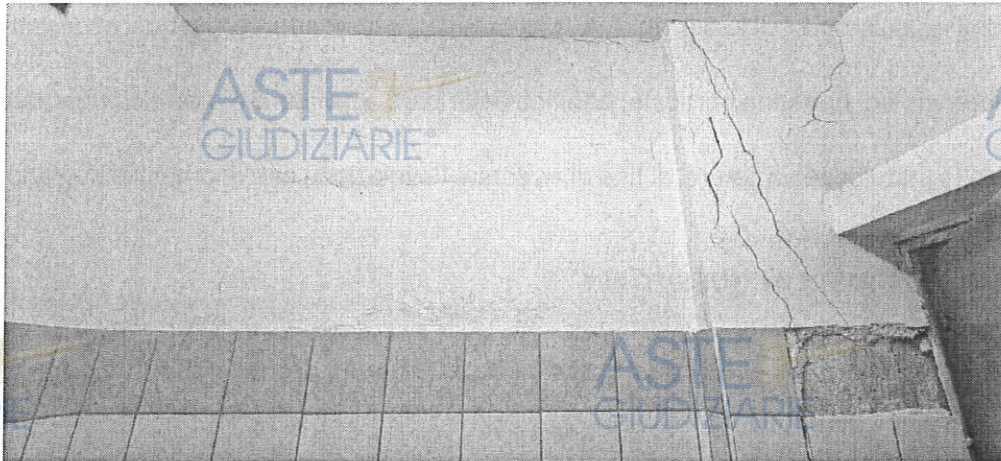
Figura 21 – Antibagno in cui sono visibili fenomeni di distacco delle piastrelle e lesioni di uno dei pilastri
