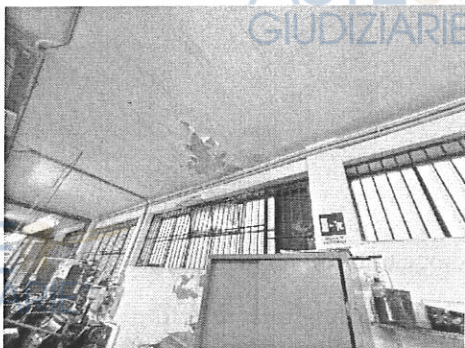
Fig. 21. Danni al soffitto ed alla parete perimetrale prospiciente la corsia carrabile (via G. Prezzolini).
