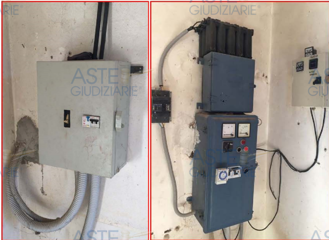
Dispositivi per l'azionamento dell'elettropompa, posti all'interno del primo vano.
