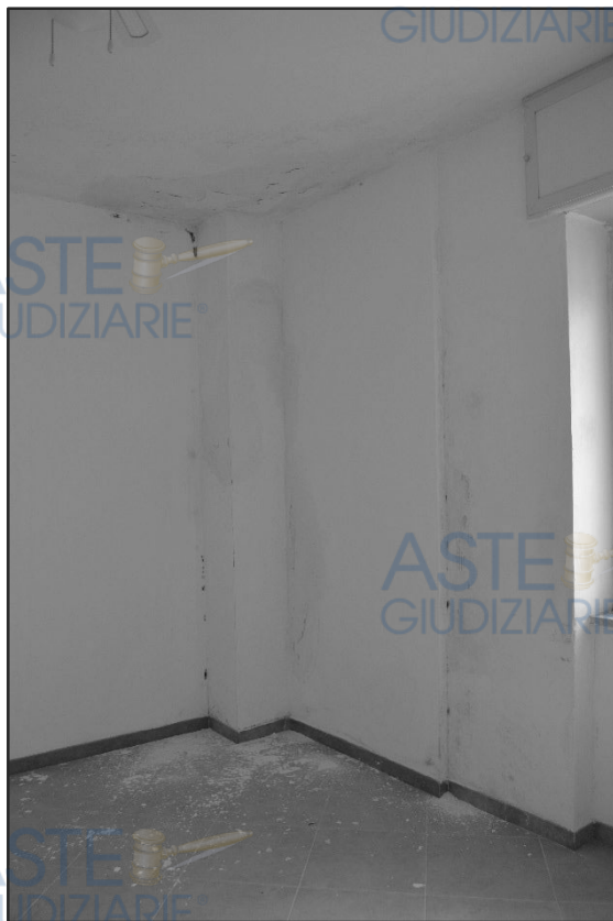
Foto 2 (tracce di fenomeni infiltrativi al soffitto ed alle pareti di uno degli ambienti al primo piano)
