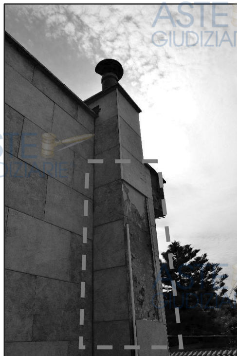
Foto 7 (Condizioni dei rivestimenti esterni al primo piano)
