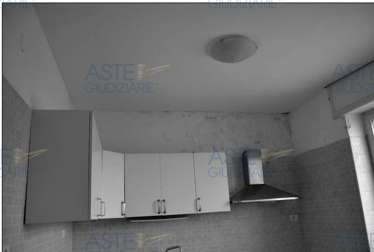
Foto 4 (tracce di fenomeni infiltrativi alle pareti della cucina al piano terra)
