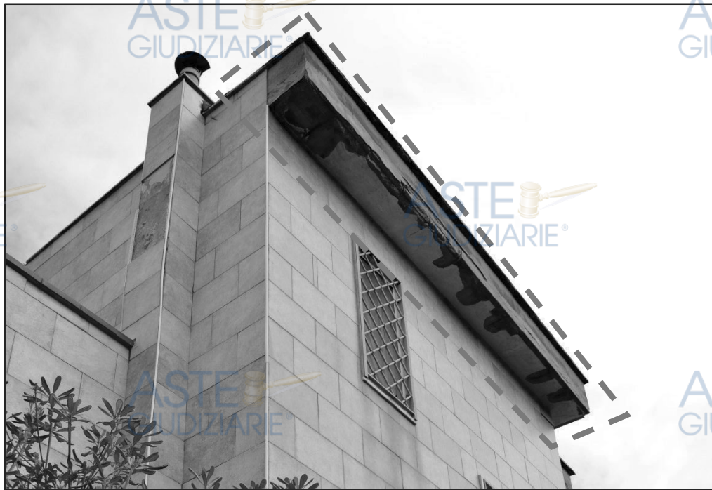
Foto 6 (condizioni del cornicione sul lato Sud)
