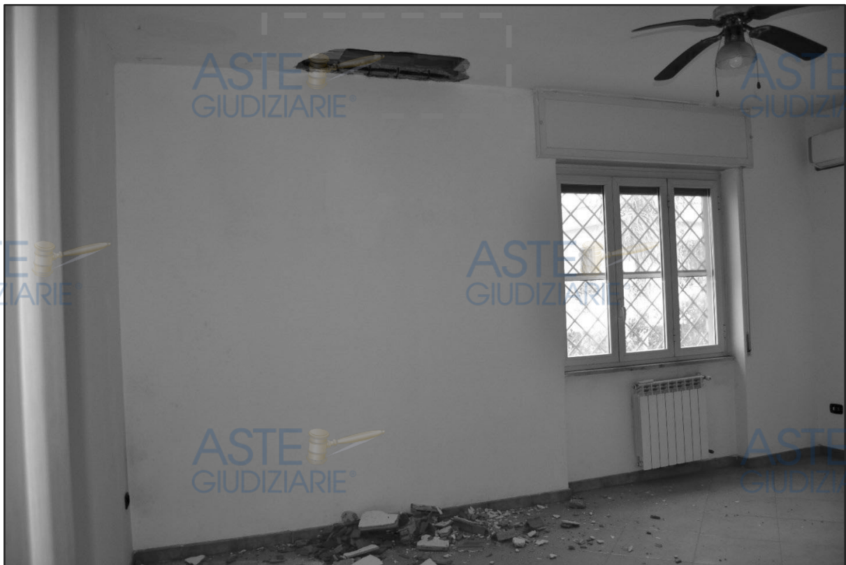
Foto 1 (solaio di copertura ammalorato dalle infiltrazioni, con conseguente caduta di calcinacci)
