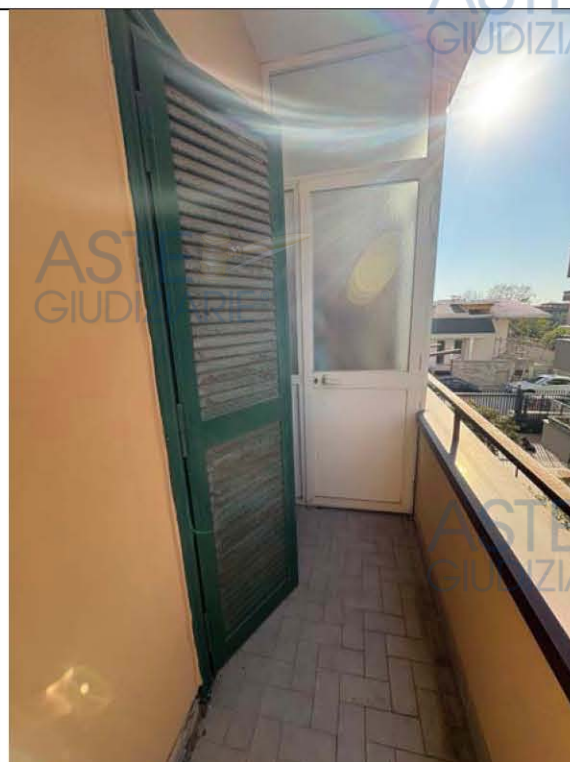
Fotografia n. 6 _ Balcone nord con deposito
