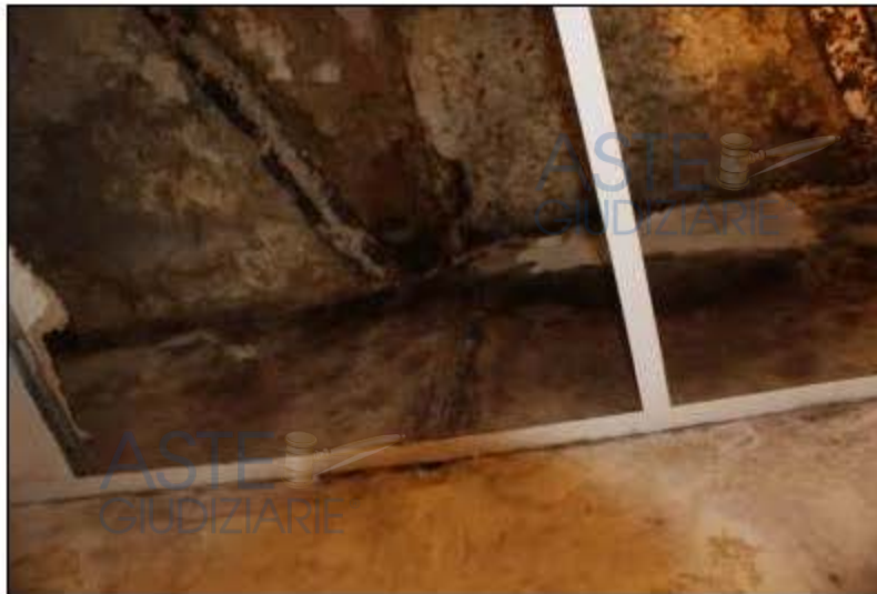
Stanza 2. La parete tra stanza 2 e il vano scala, sotto la controsoffittatura, presenta ampie alonature di colore scuro, erosioni e distacchi di intonaco, presenza di muffa.
