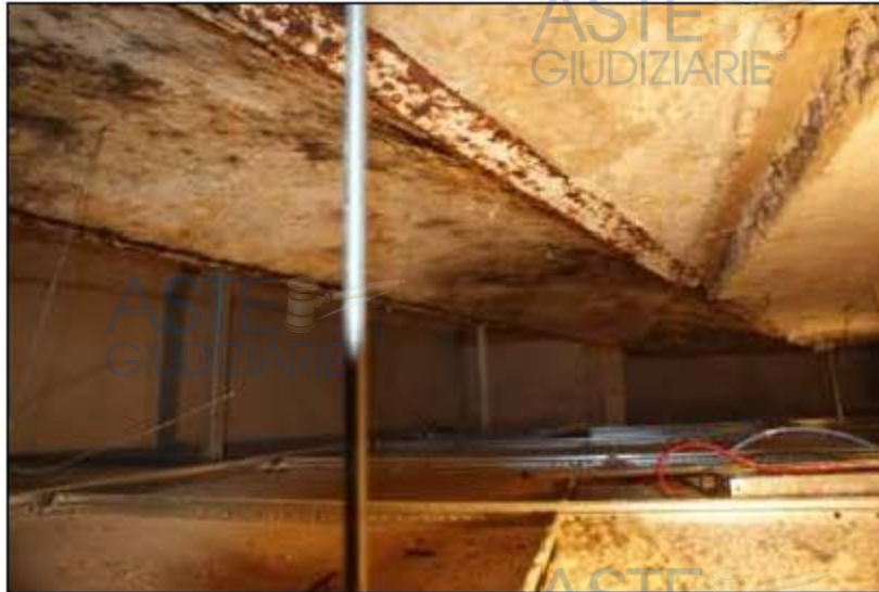
Stanza 2. L'intradosso del solaio del tipo a voltine presenta segni di eventi infiltrativi e putrelle corrose.
