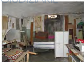
Fotografia 22 - Locale 2: L'ambiente dispone di una lustriera a "bocca di lupo" prospiciente la strada pubblica di Vico Sant'Elframo Vecchio. L'ambiente si presenta in un totale stato di abbandono, occupato da diversi mobili e materiali di ogni genere, le pareti mostrano segni diffusi di efflorescenze di macchia di umidità da risalita, anche il soffitto presenta diffuse macchie di umidità con fenomeni di distacco dello strato superficiale di gesso.
