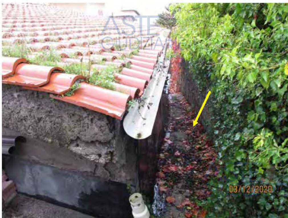
Fotografia 18 – Terrapieno addossato al prospetto nord dell'edificio pignorato.
