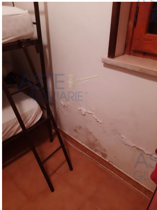
Umidità di risalita
