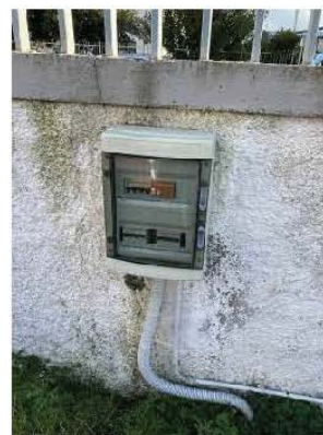
Quadro elettrico esterno
