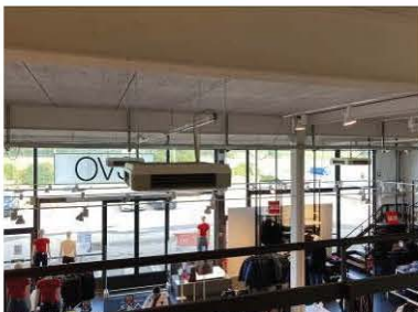
1 delle 12 ventilanti interne
