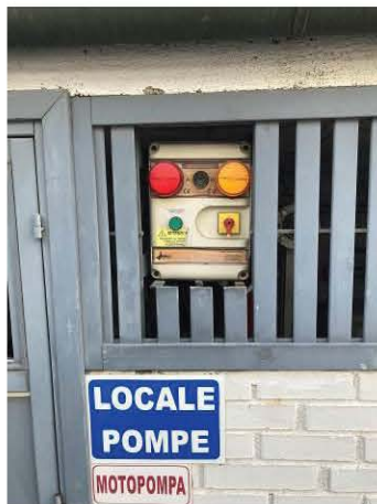
Interruttori esterni poma antincendio
