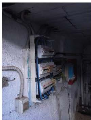
Quadro elettrico magazzino
