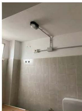
Impianto in tubazione PVC
