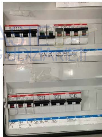
Quadro elettrico uffici
