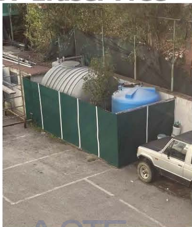
Cisterna antincendio (grigia)
