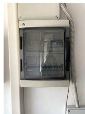
Quadro elettrico piano ammezzato
