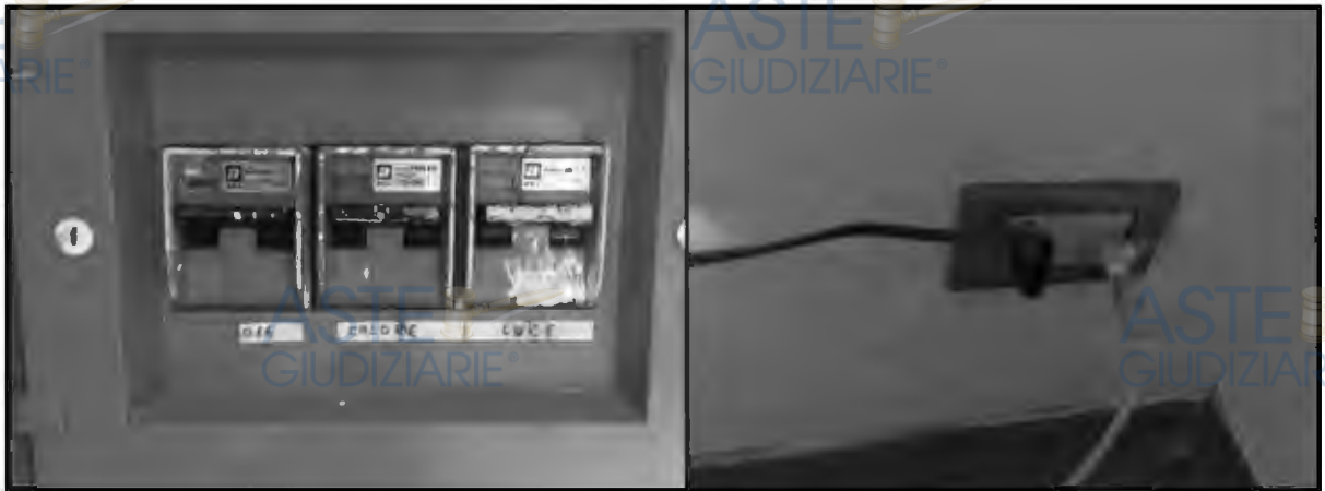
Impianto elettrico: quadri elettrico e dettaglio impianto nel sub. 2
