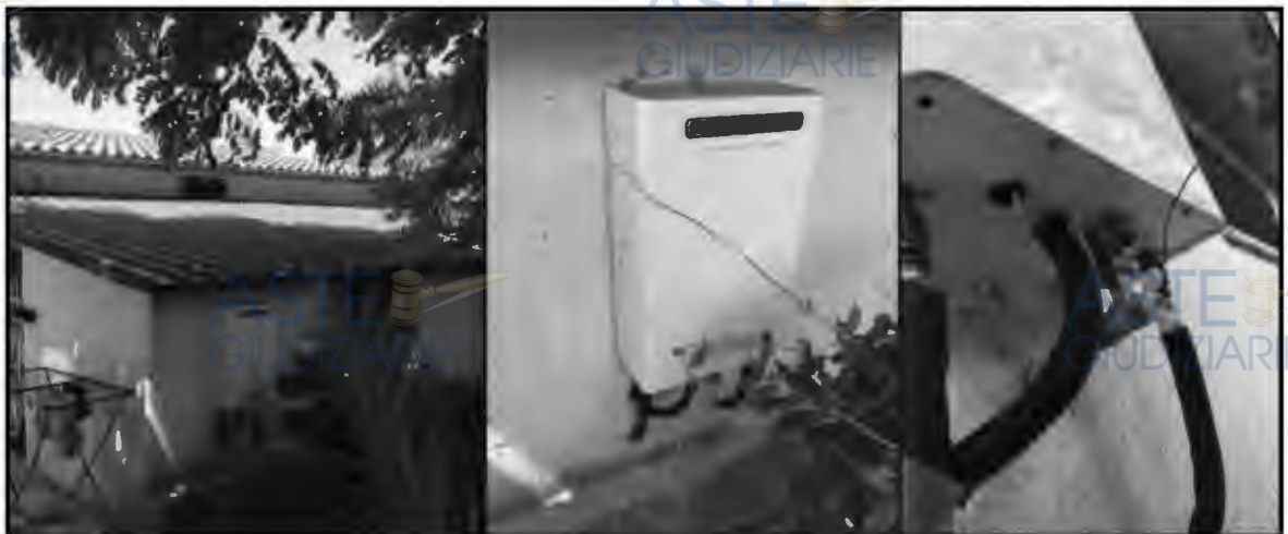
Caldaia per ACS nella p.lla 313
