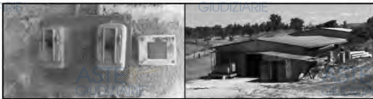
Impianto elettrico: interruttori nel capannone agricolo
