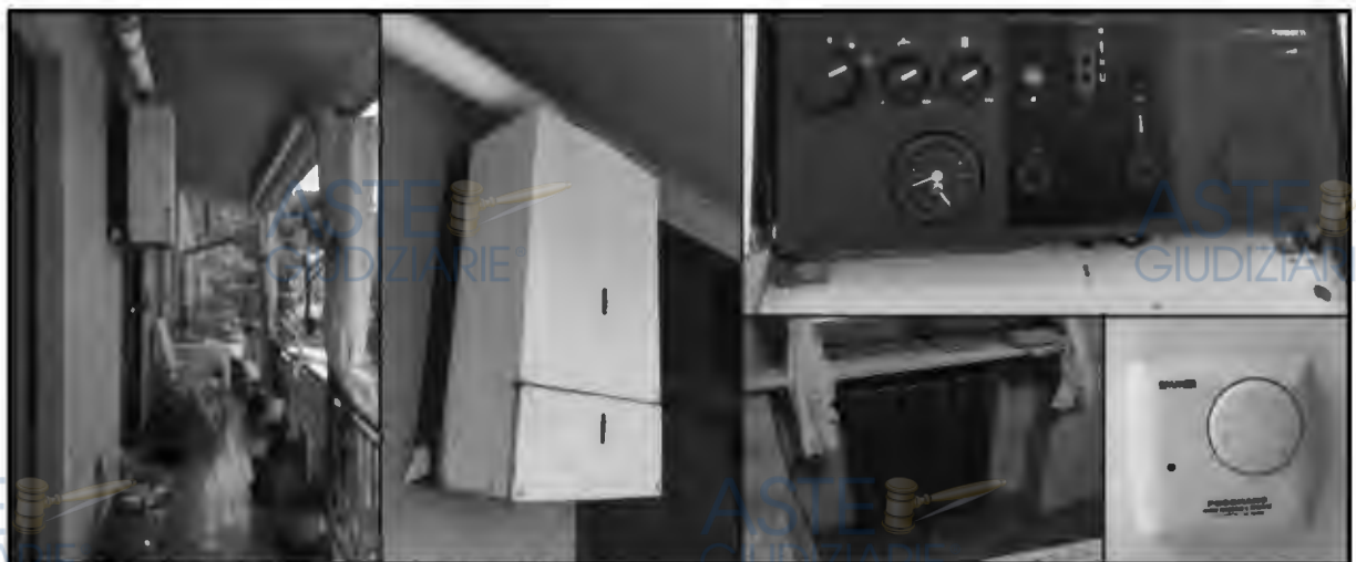
Caldaia, radiatori e termostato nel sub. 3
