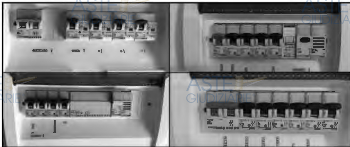
Impianto elettrico: quadri elettrici nella struttura ricettiva
