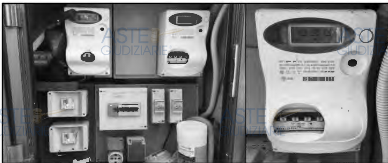
Impianto elettrico: punto di fornitura con contatore
