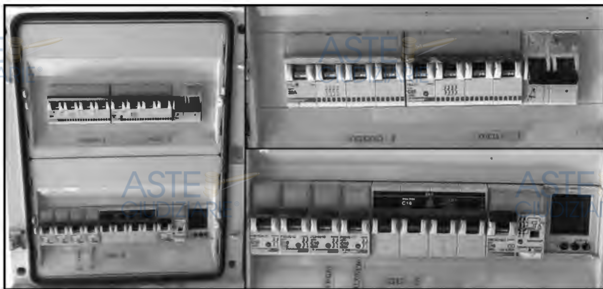
Impianto elettrico: quadro elettrico principale nella p.lla 313
