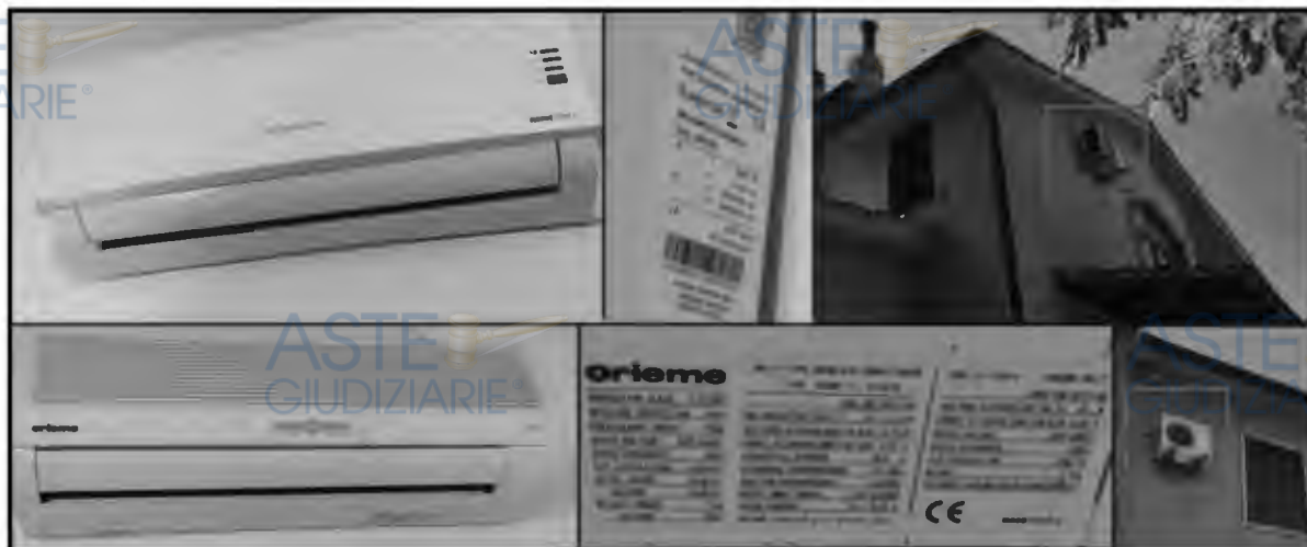
Split e pompe di calore nel sub. 3
