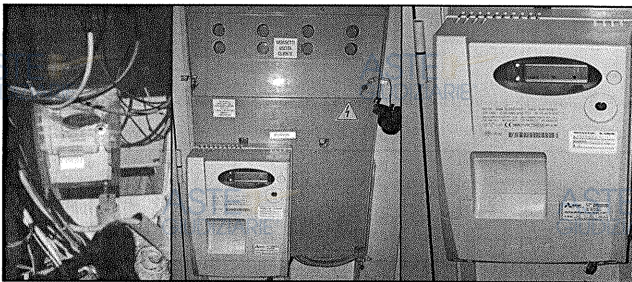
Impianto elettrico: punto di fornitura e contatore
