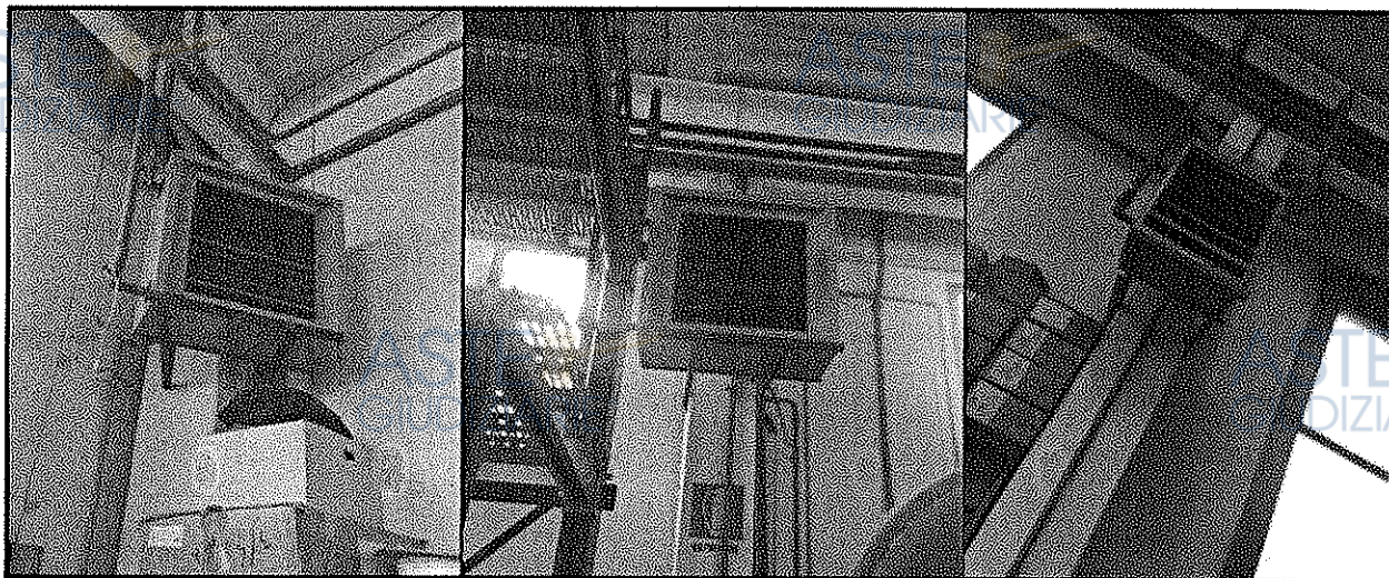
Ventilconvettori: 2 maggiori, e 9 minori, sistemati lungo il perimetro della sala principale delle lavorazioni
