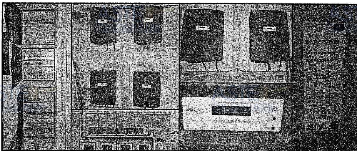
Impianto fotovoltaico: quadri elettrici e inverter
