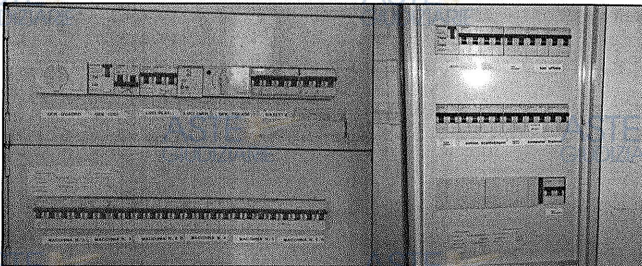
Impianto elettrico: quadro elettrico n°3 e n°4
