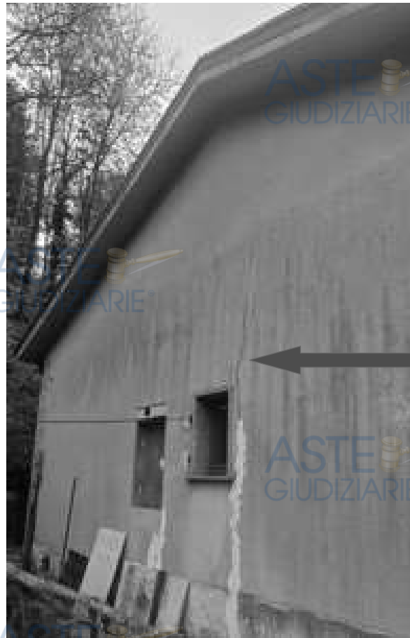
immagine 5: crepa sul prospetto laterale
