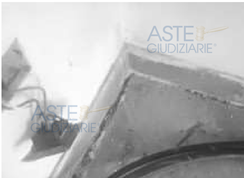
immagine 7: distacco muratura a livello fondazionale (interno)
