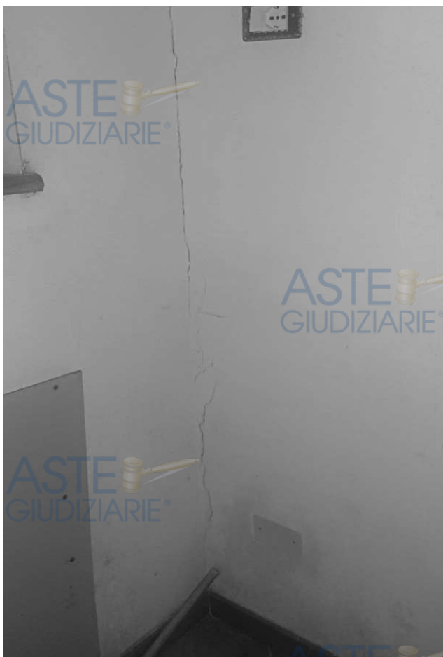
immagine 8: distacco pareti interne
