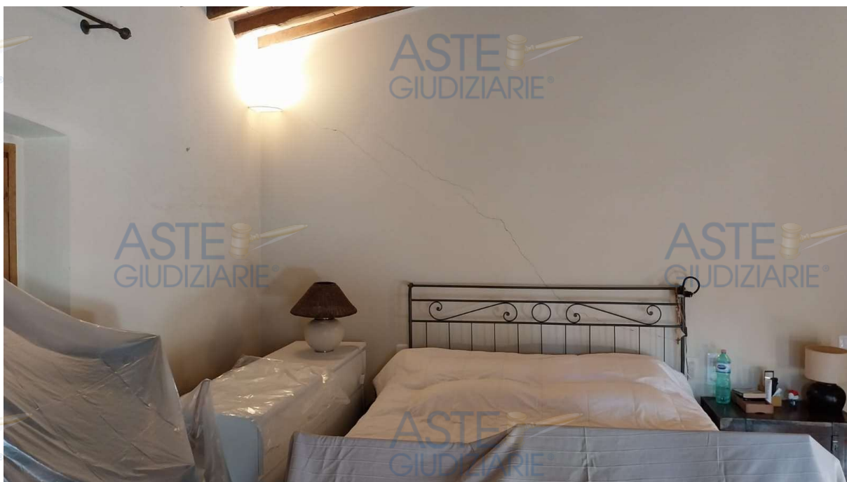
Lesione parete piano primo divisione camera - bagno
