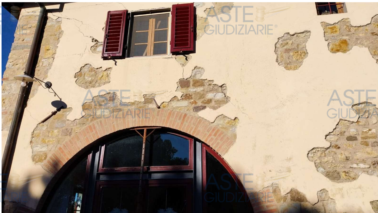
Particolare spigolo facciata principale con lesioni
