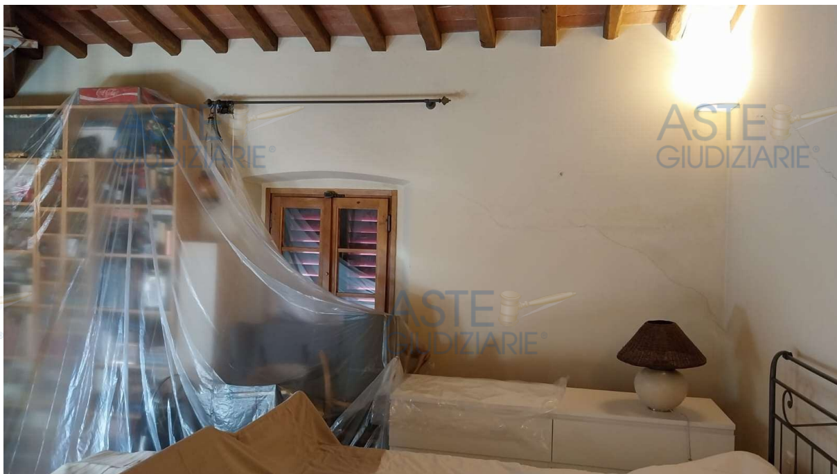
Vista lesione parete interna piano primo lato prospetto laterale
