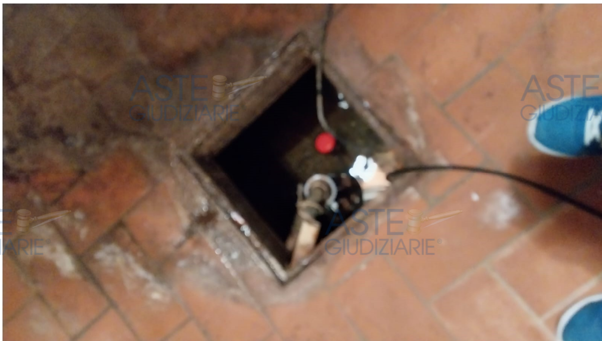
Pozzatto raccolta acque e pompa sommersa
