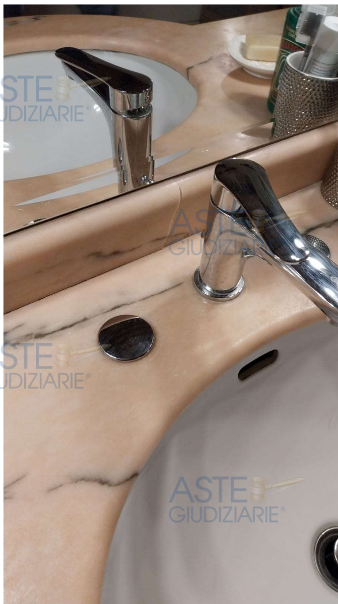
Danneggiamento marmo bagno
