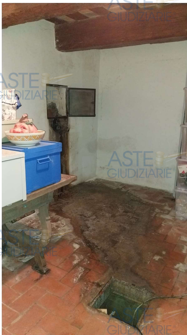
Vista Locale interrato e percolazione
