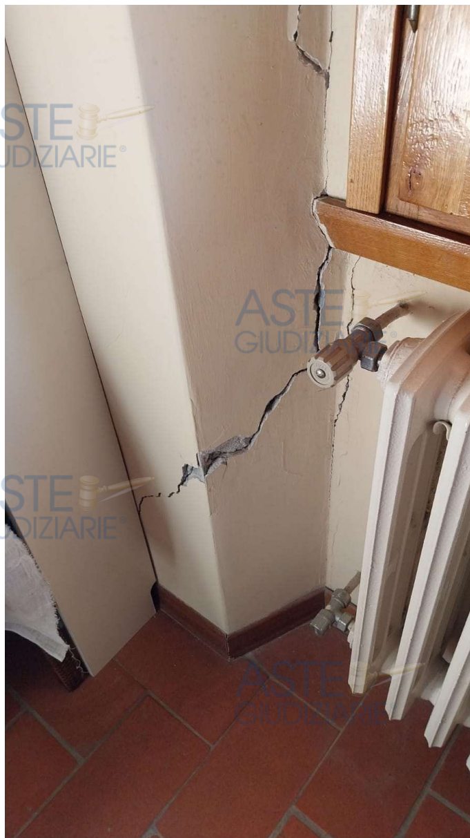
Lesione sottofinestra piano primo su prospetto principale
