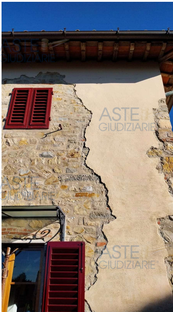
Particolare spigolo facciata laterale con lesioni
