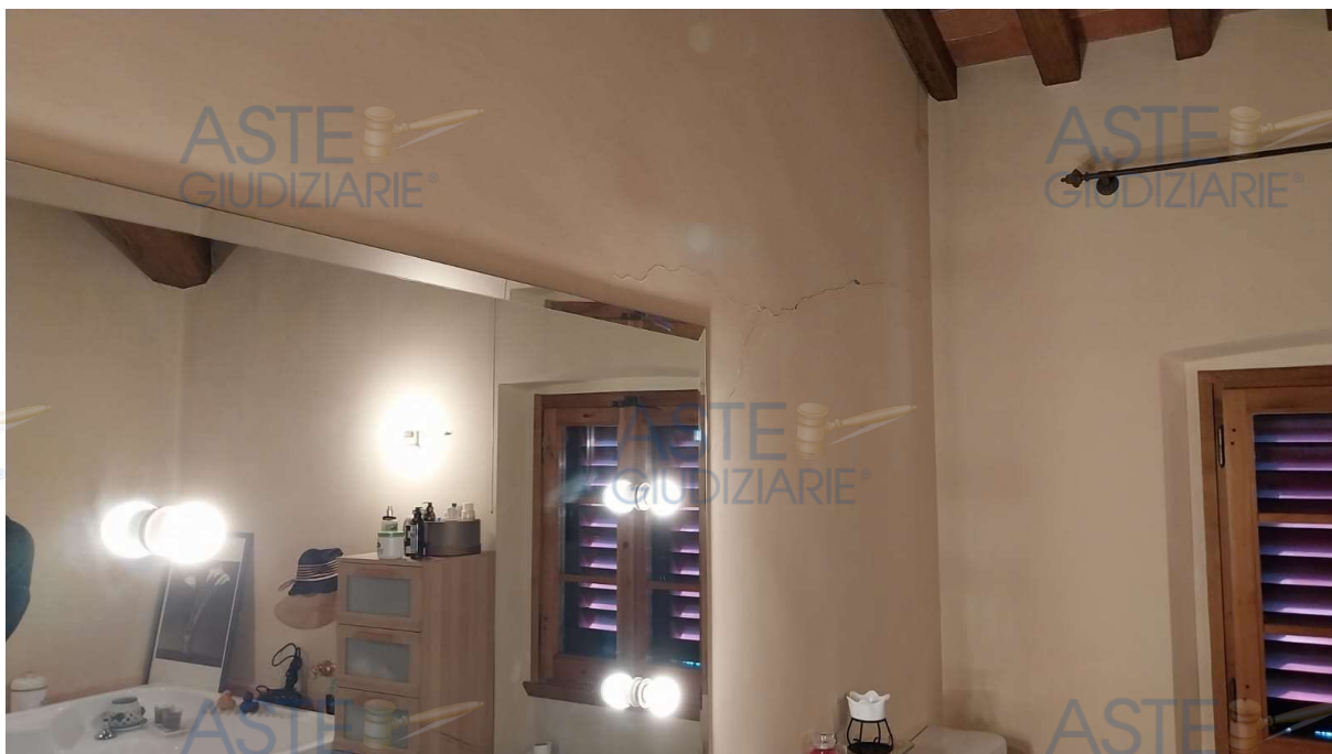
Lesione parete piano primo divisione camera – bagno da locale bagno
