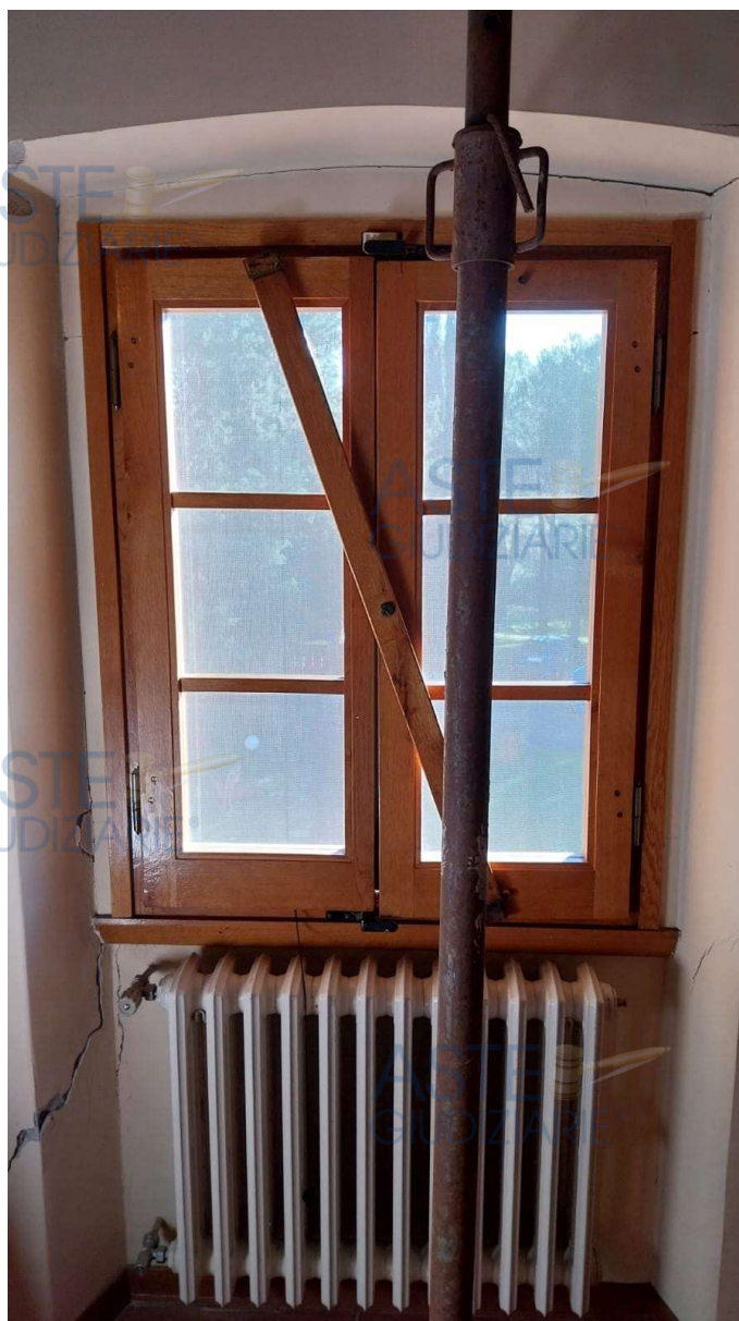
Vista Particolare finestra soqquadrata e lesioni
