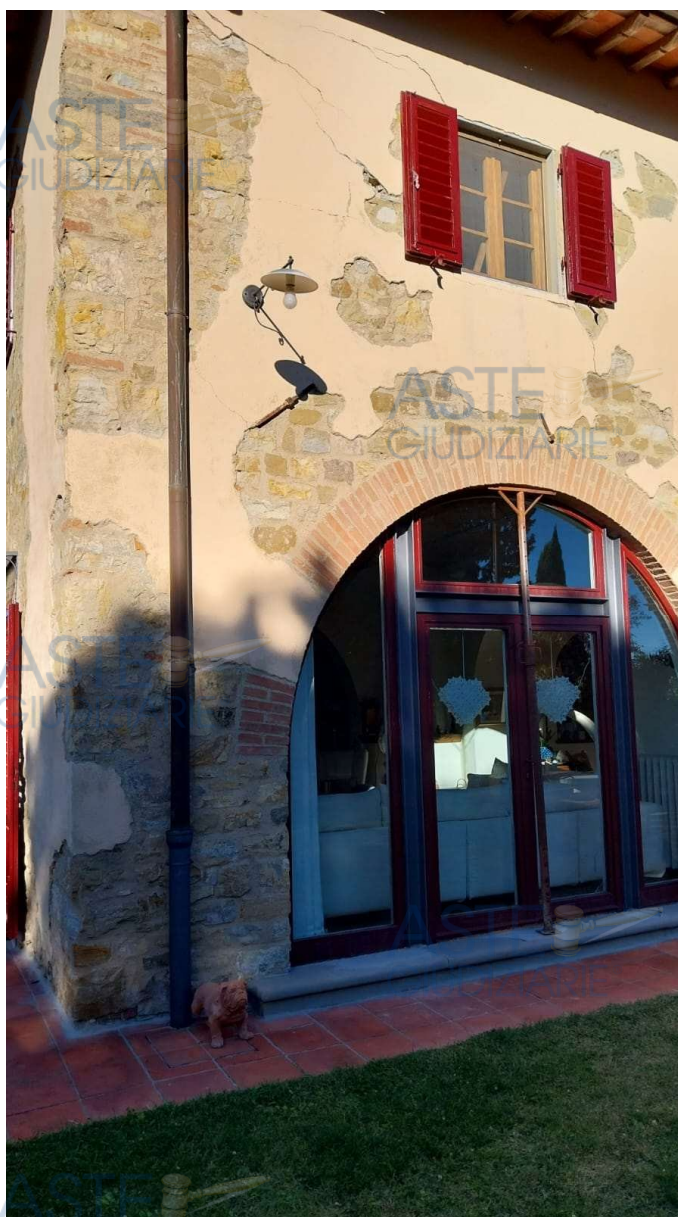
Particolare spigolo facciata principale con lesioni
