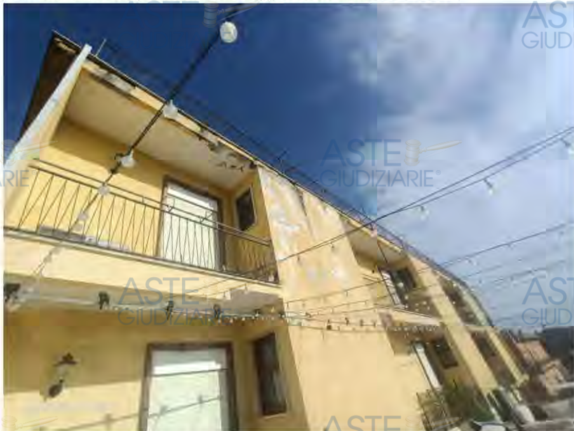
Danni da infiltrazioni da acque meteoriche
