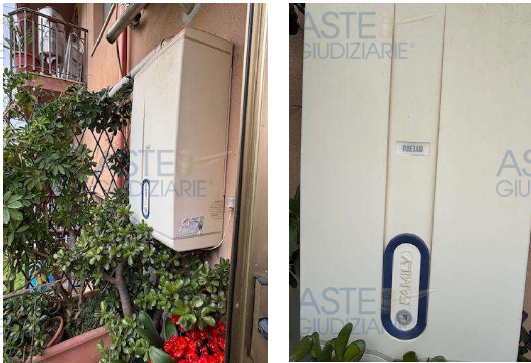
Figura 8: Caldaia posta sul balcone nell'unità immobiliare in oggetto
