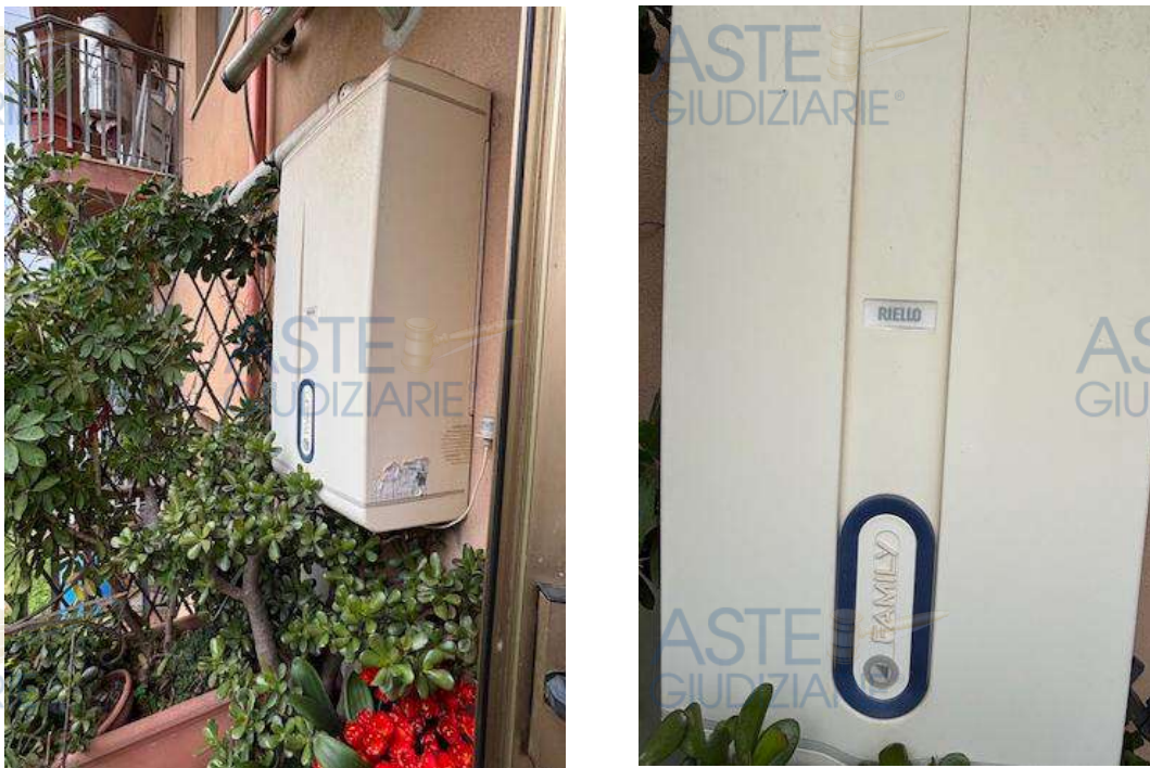
Figura 8: Caldaia posta nell'unità immobiliare al piano primo subalterno 4 che al momento serve anche il subalterno 2 in oggetto
