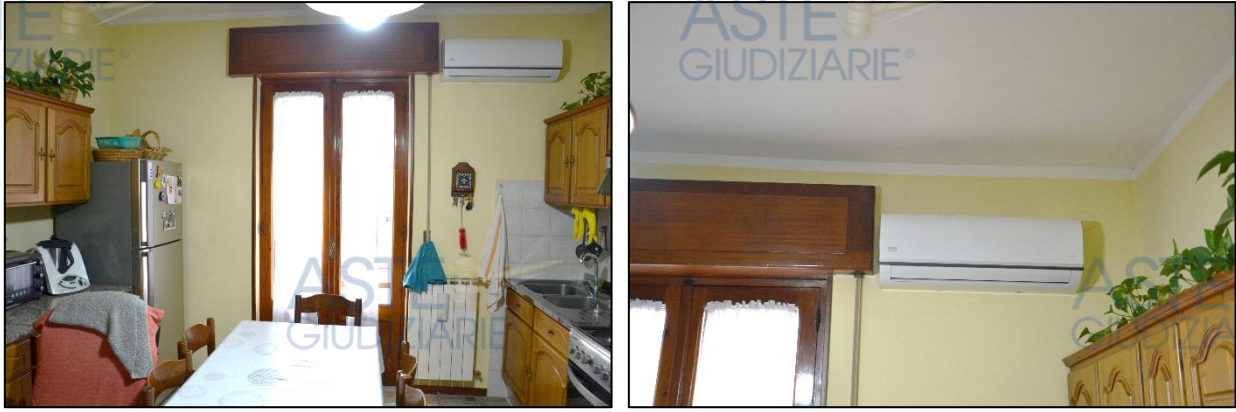
Figura 21 - Split vano CUCINA
