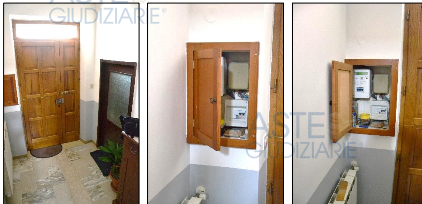
Figura 17 - Contatore energia elettrica
