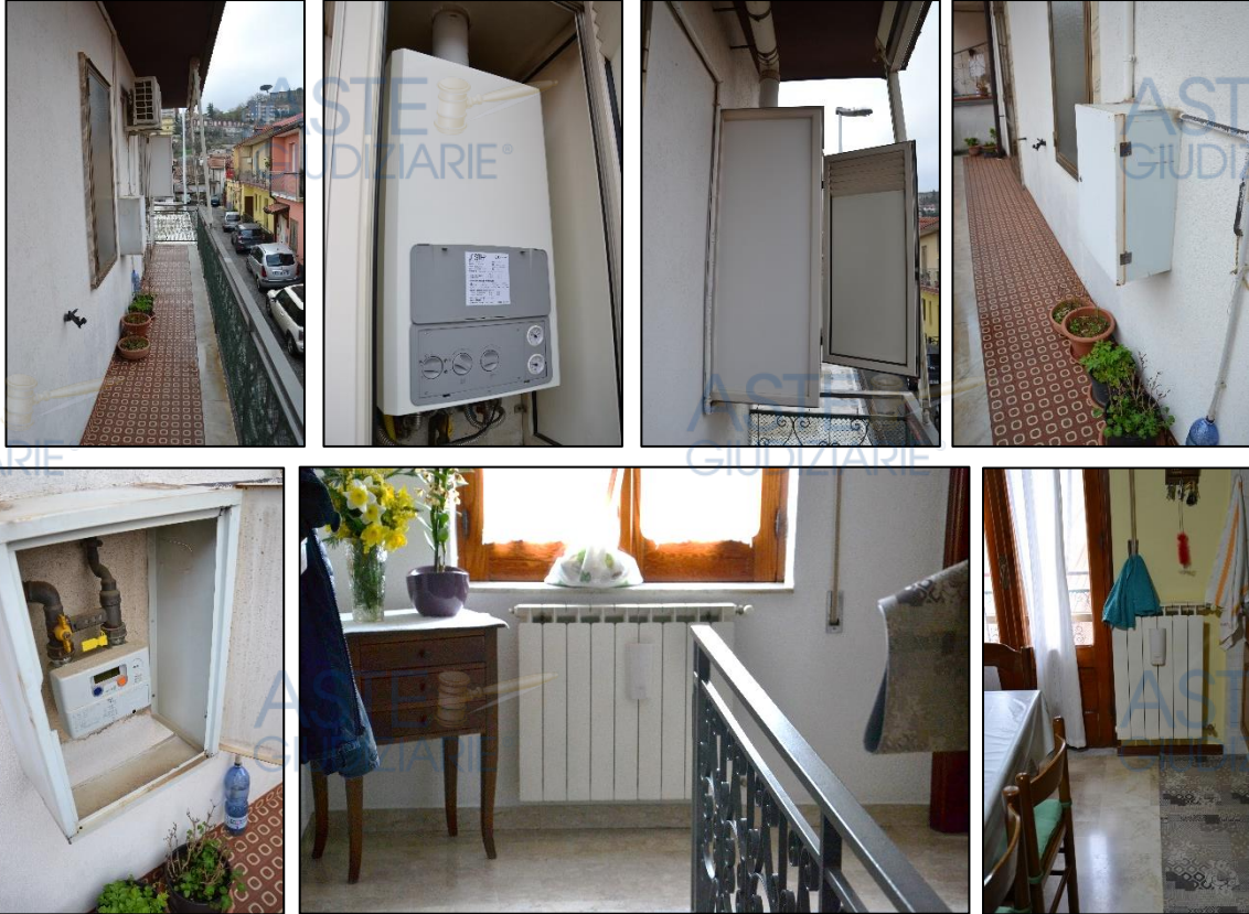
Figura 19 – Contatore gas metano e caldaia
