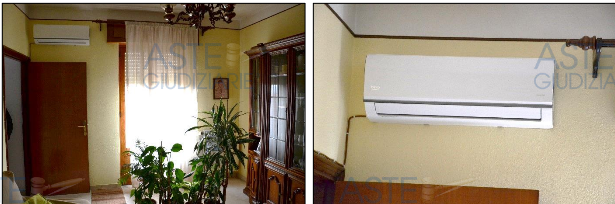
Figura 20 - Split vano SOGGIORNO
