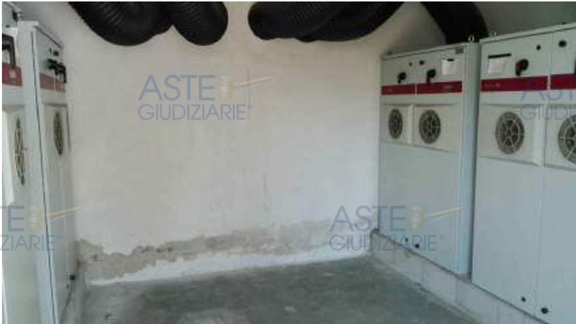
Foto 85. Locale deposito, utilizzato per l'impianto fotovoltaico.
