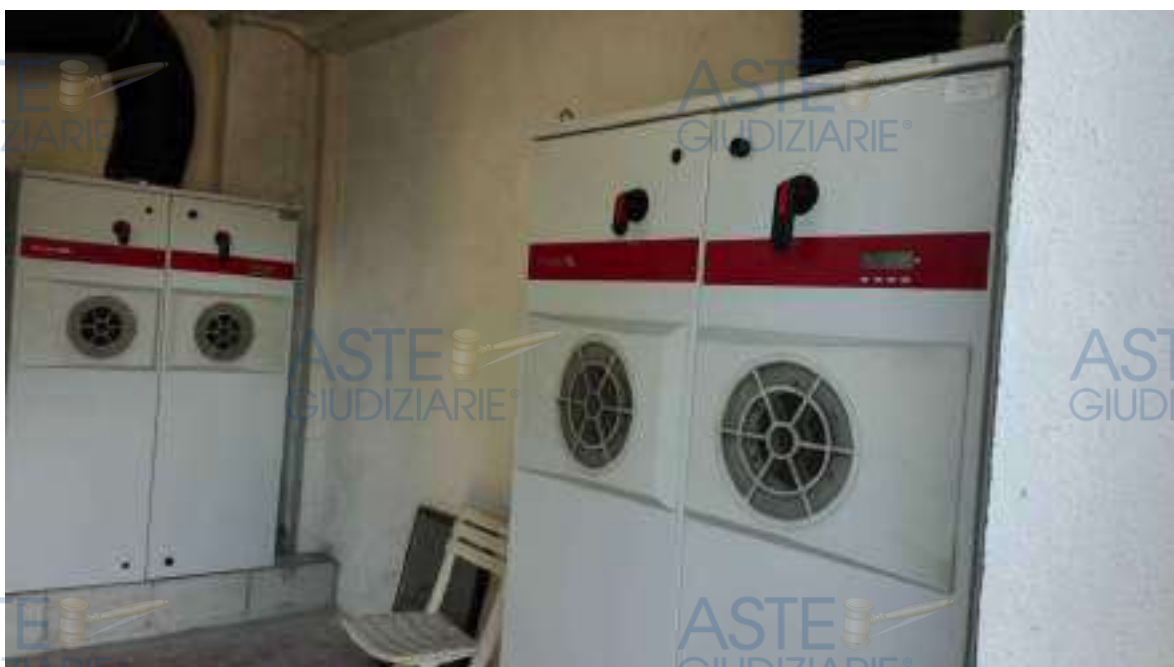
Foto 71-72-73. Locale deposito inverter dell'impianto tecnologico fotovoltaico.
