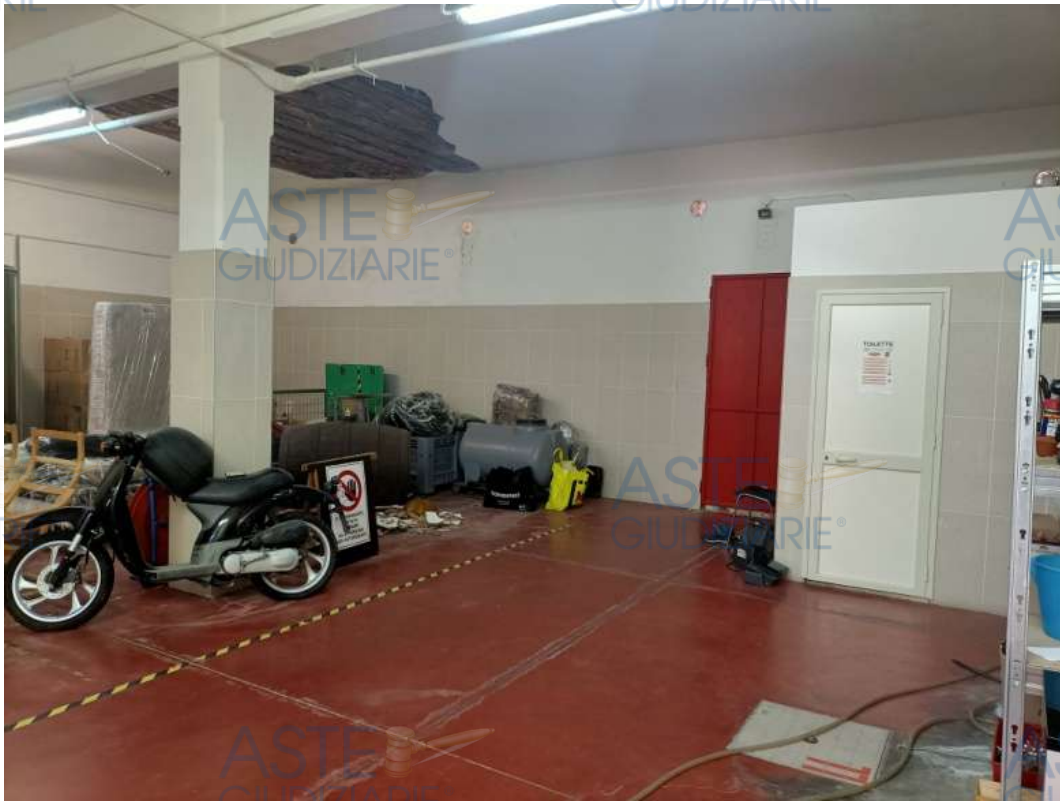
Interno primo vano con vista dello sfondellamento
