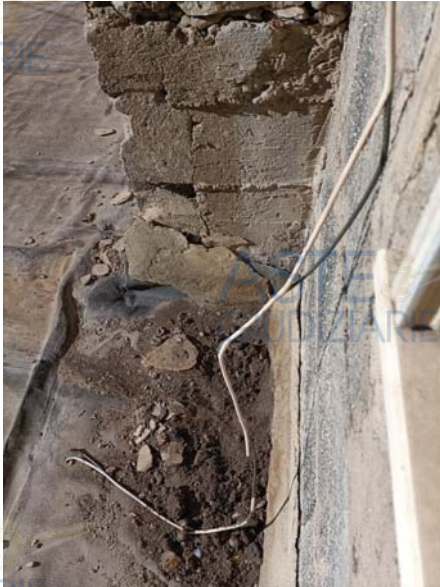
Figura 10 – particolare del risvolto della guaina scollato dalla parete
