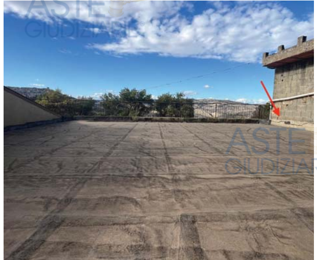
Figura 11 – lastrico solare – scollamento del risvolto della guaina
