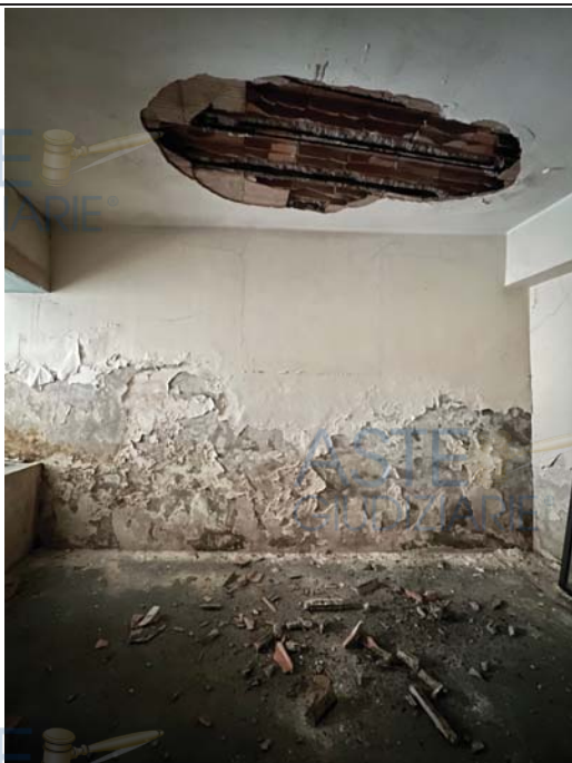
Figura 5 – Interno del LOTTO 9 – segni di umidità proveniente dal terrapieno
