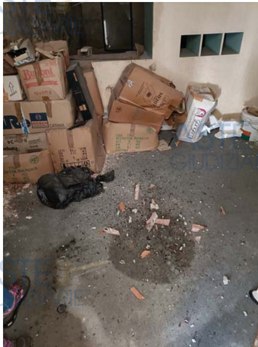
Figura 3 – Interno del LOTTO 9 – segno di gocciolamento e caduta di laterizi dal solaio di copertura
