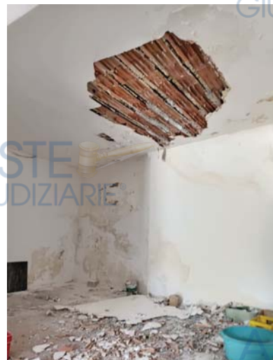
Figura 13 – Immobile sottostante il LOTTO 9 particolare del soffitto/solaio intermedio
