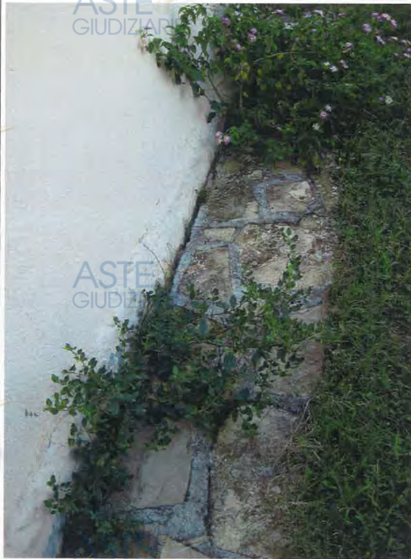
foto n. 15 – distacco e cedimento fondazione marciapiede
