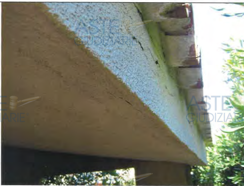
foto n. 14 – fessurazione e inizio distacco copriferro cornice post.
