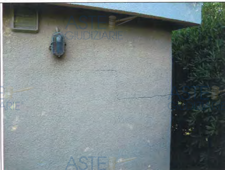
foto n. 7 – fessurazioni a scaletta esterne
