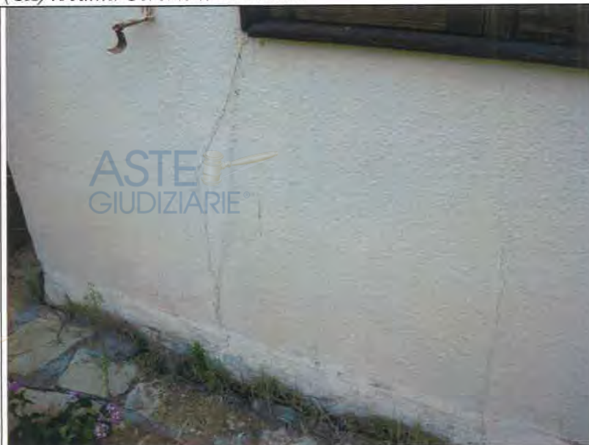
foto n. 6 – fessurazioni dinamiche sottosoglia
