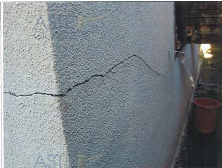
foto n. 8 – particolare fessurazioni dinamiche
