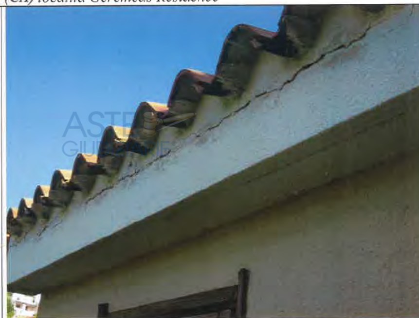
foto n. 2 – fessurazioni e distacco copriferro cornice anteriore
