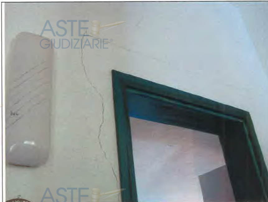
foto n. 4 – fessurazioni dinamiche soggiorno
