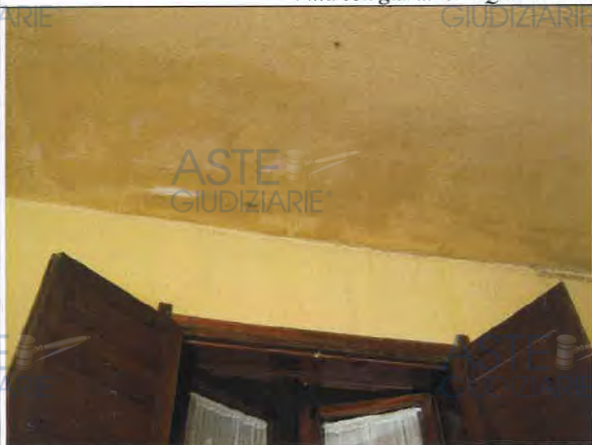
foto n. 5 – umidità da infiltrazione proveniente dal tetto loggiato
