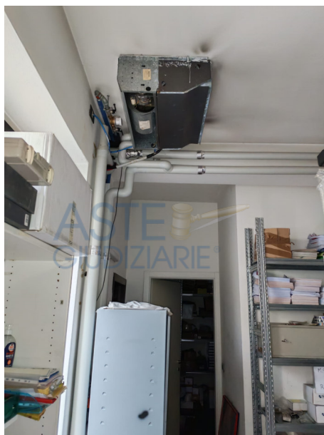
Particolare riscaldamento : fancoil
