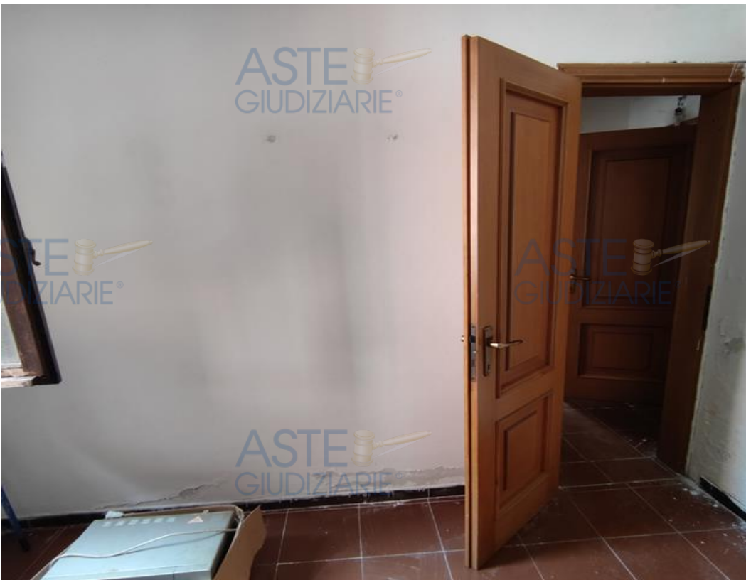
A sinistra e destra nella fotografia i danni interni dovuti alla rottura impianto idrico ( zona locale a disposizione)
