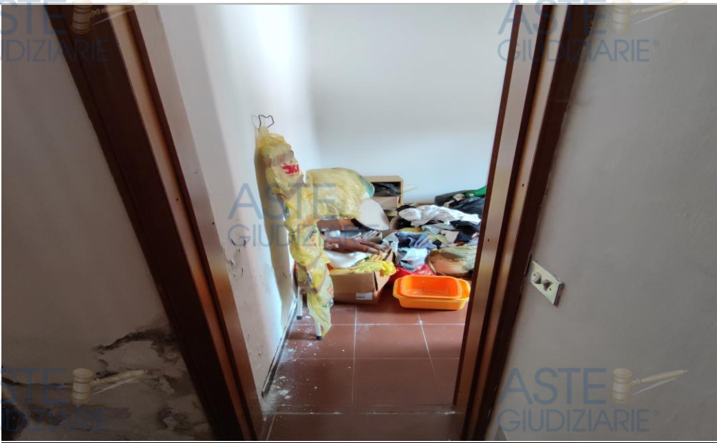
A sinistra nella fotografia i danni interni dovuti alla rottura impianto idrico ( zona disimpegno)
