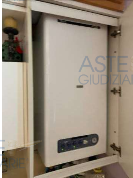
Figura 12: Caldaia installata in cucina
